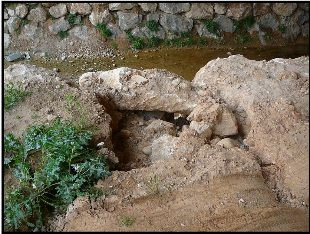
23. Erosión en escollera de protección, margen izquierda aguas abajo.
