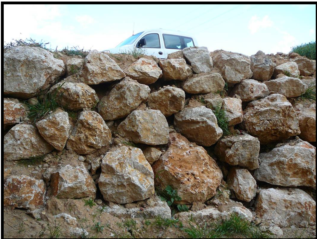
22. Escollera de protección en margen izquierda.
