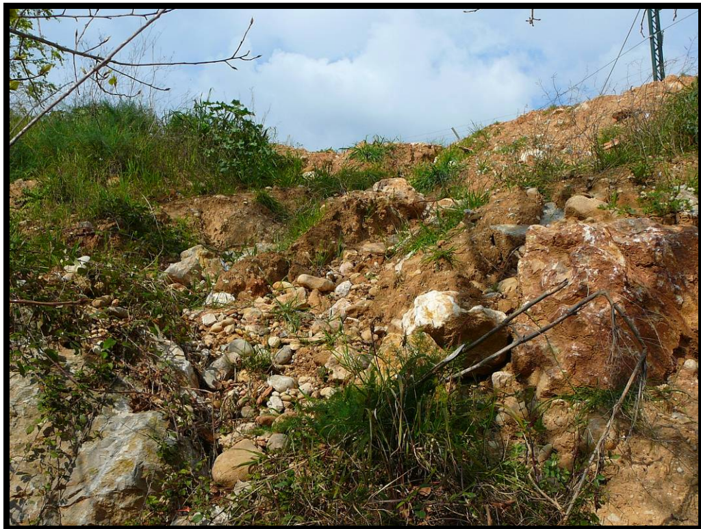
24. Erosión en la margen izquierda de aguas arriba.
