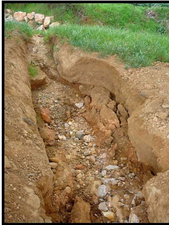
25. Erosión en margen derecha a la altura de la pila 8.
