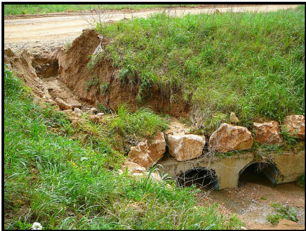
26. Erosión en zona de desagüe, bajo vano 8.
