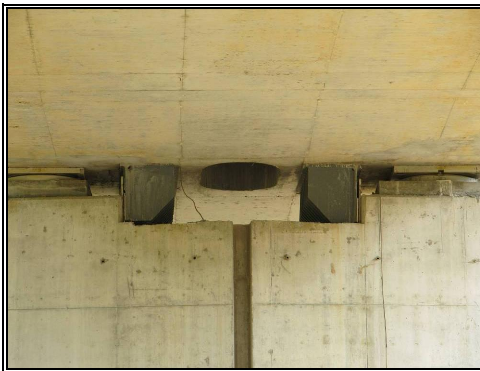
Nº 6.- Detalle de dispositivo antisísmico colocado en pila.
