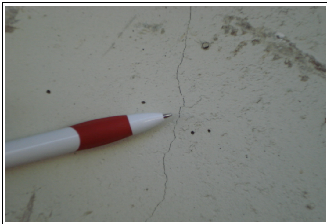
Foto 9: Fisuración Vertical en paramento de Hormigón
