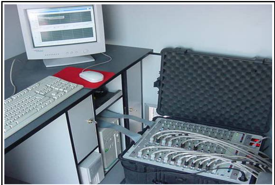
Foto 10: Vista general de acondicionadores de señal y equipo de adquisición
