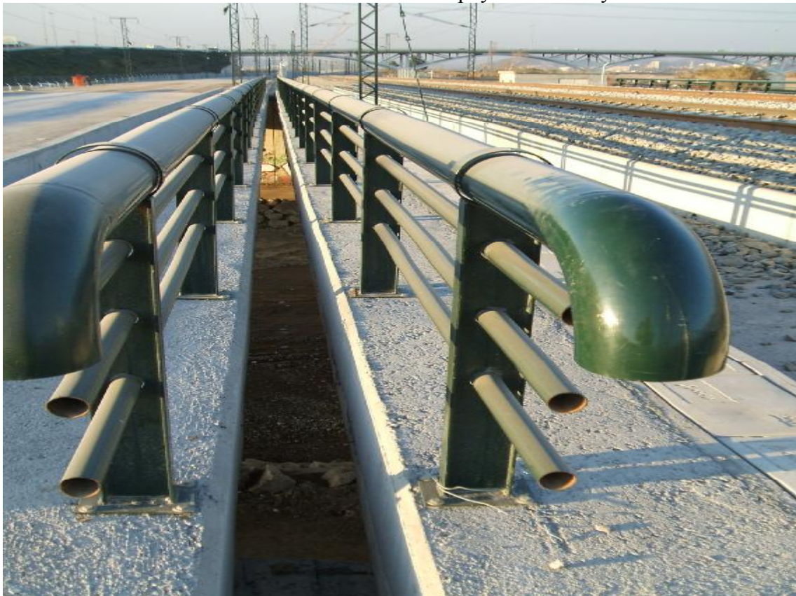
FOTOGRAFIA N°12: Detalle del estado de las barandillas.
