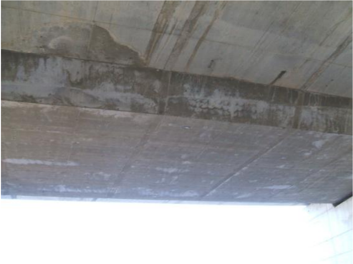
FOTOGRAFIA N°9: Detalle de la humedad y su marca de eflorescencia.
