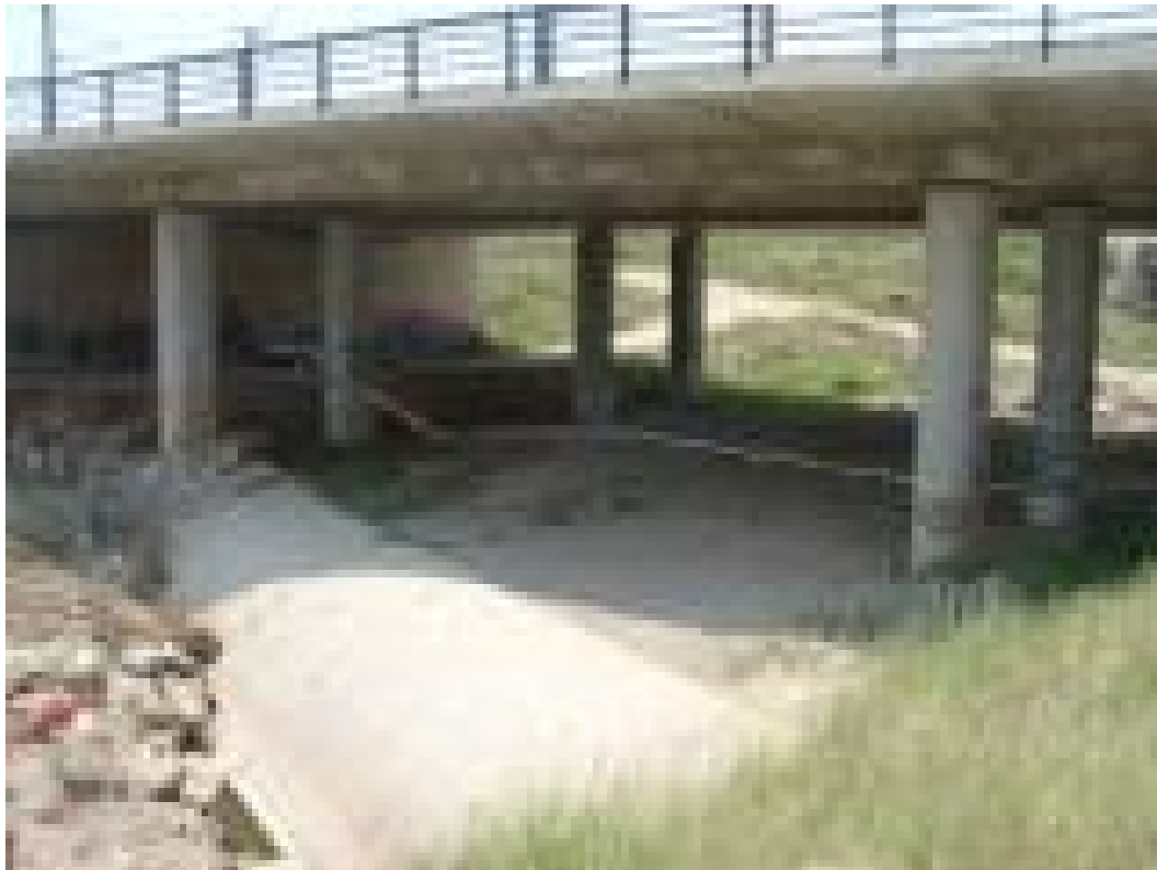
FOTOGRAFÍA N° 10: SOCAVAMIENTO AGUAS ARRIBA.
