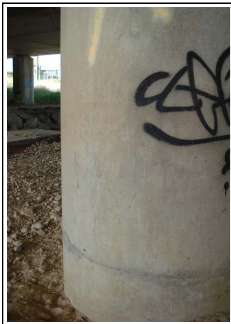
Foto 19: Nivel de agua alcanzado en pila_1
