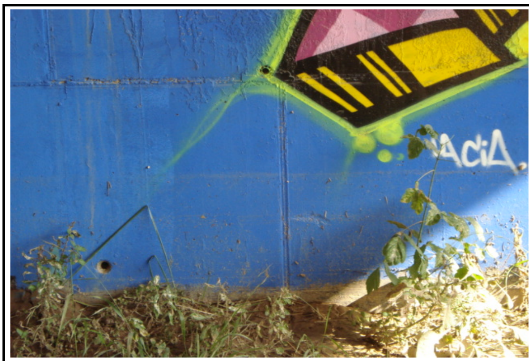
Foto 21: Nivel de agua alcanzado en estribo de salida
