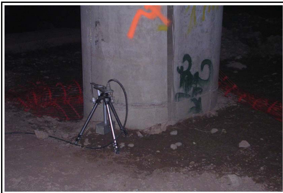
Foto 5: Ménsulas para la medida de flechas de apoyos en pilas.
