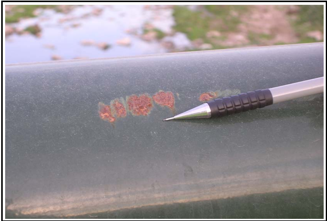
Foto 11: Picaduras en barandillas
