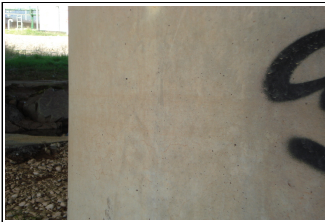
Foto 20: Nivel de agua alcanzado en pila_2
