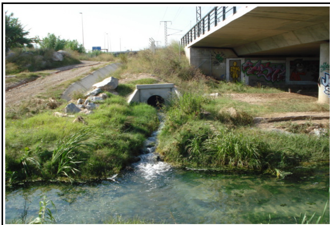
Foto 18: Aportación de aguas residuales en margen derecha aguas arriba
