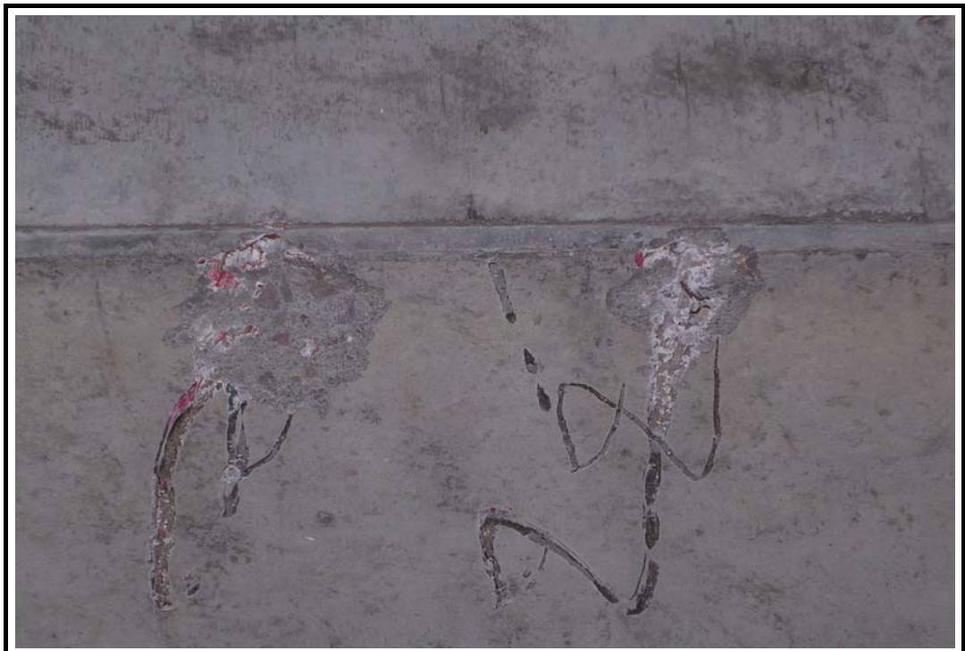
Foto 8: Golpe en losa
