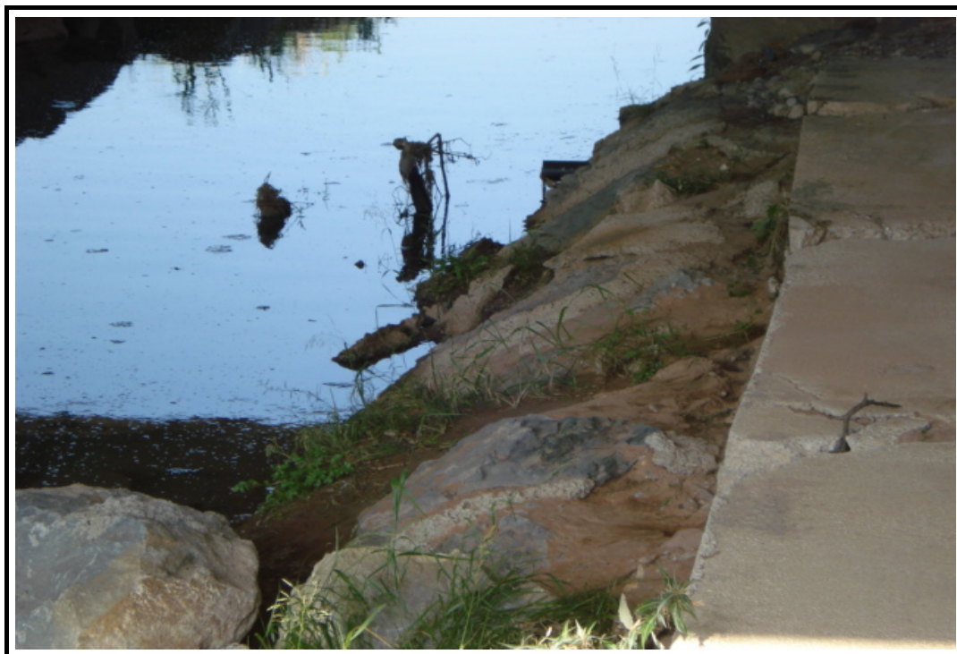
Foto 16: Escollera en margen derecha bajo la estructura
