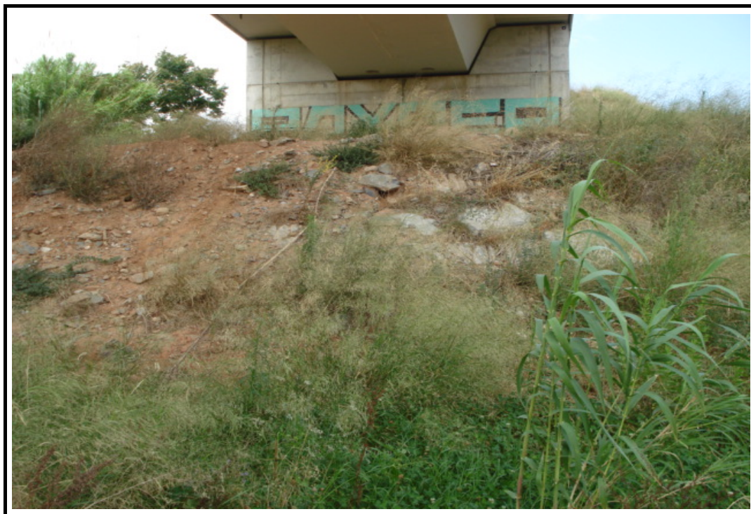
Foto 17: Escollera en margen derecha bajo la estructura
