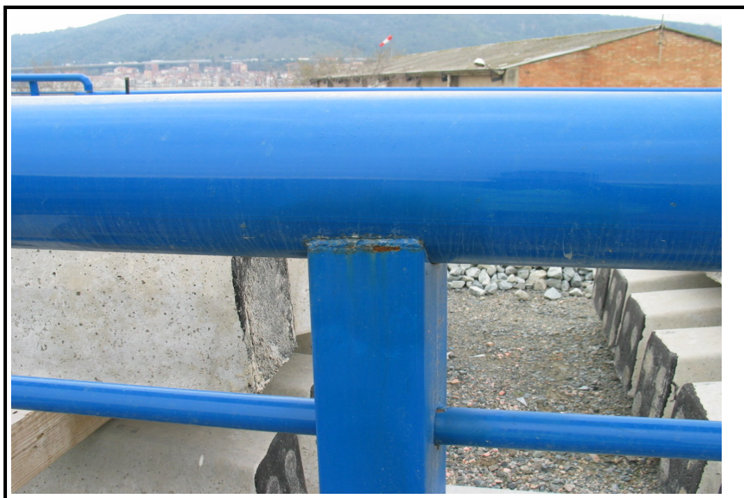
Foto 7: Picaduras en barandilla
