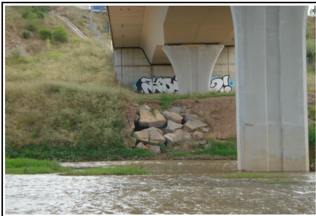
Foto 18: Daños en escollera de margen izquierda bajo la estructura
