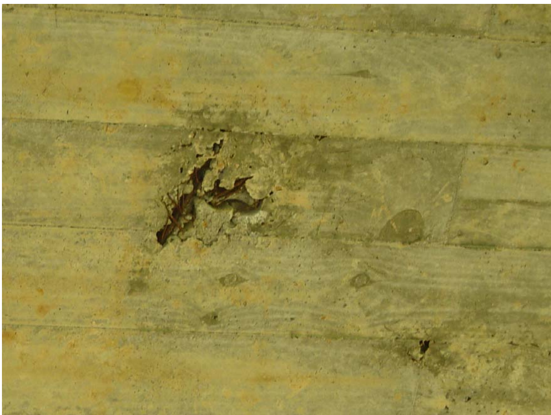
FOTOGRAFIA N°9: Nido de grava y vista somera tablero.
