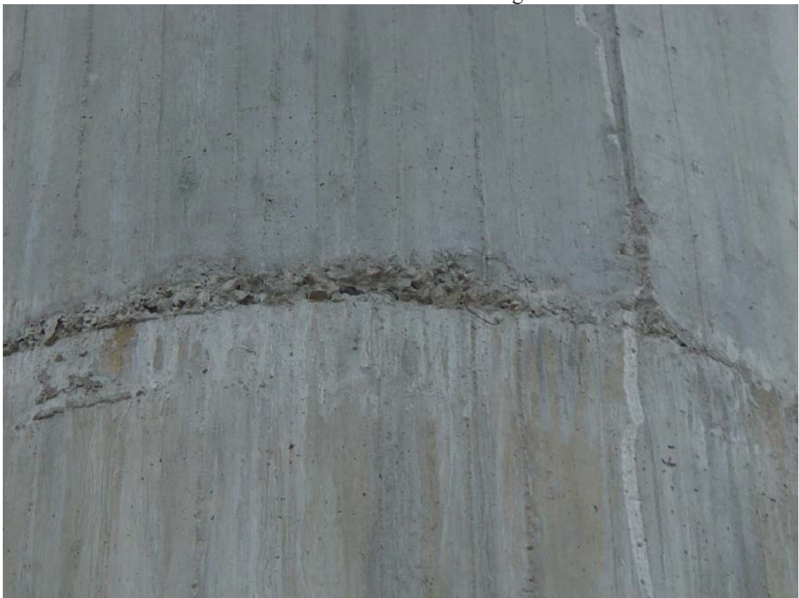
FOTOGRAFIA N°12: Detalle nido de grava pila.
