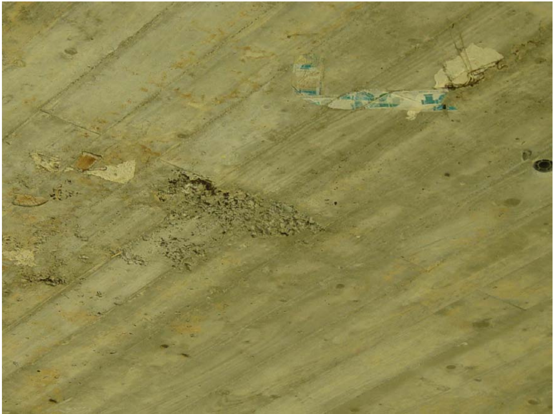
FOTOGRAFIA N°11: Detalle nido de grava tablero.
