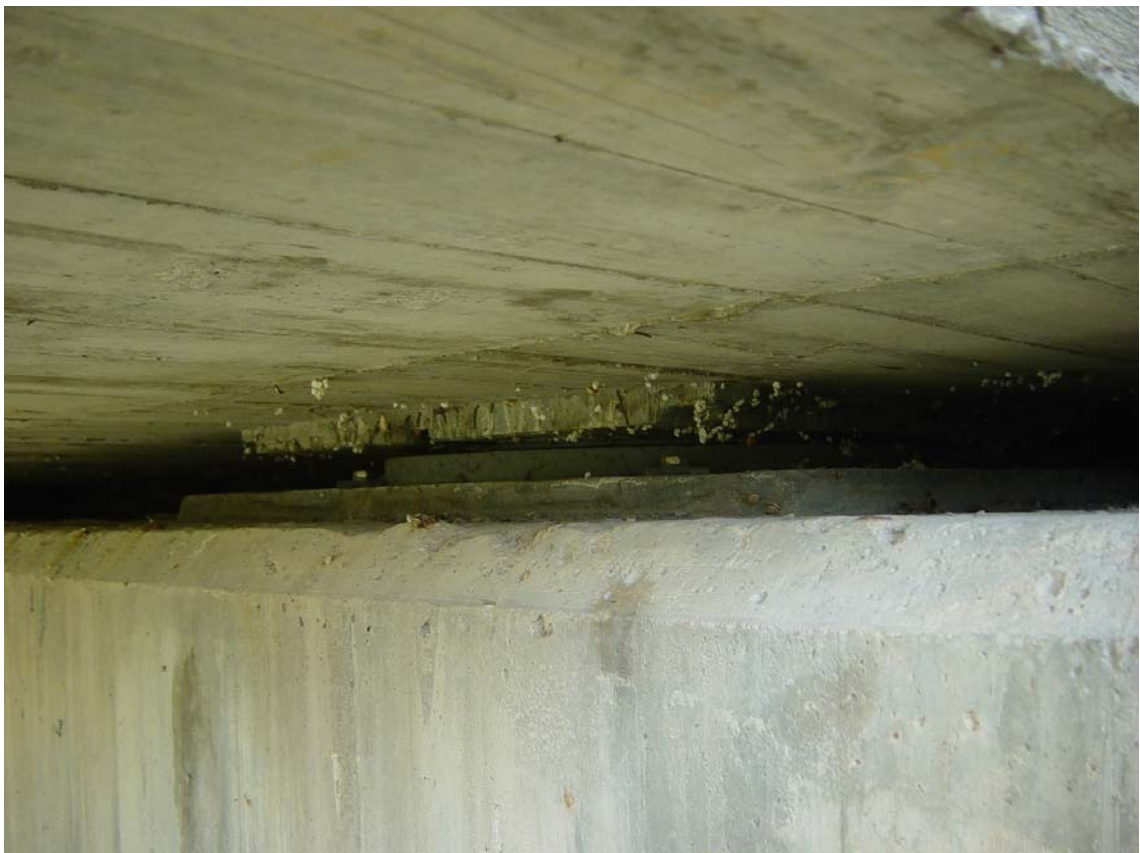
FOTOGRAFIA N°8: Detalle suciedad apoyo.
