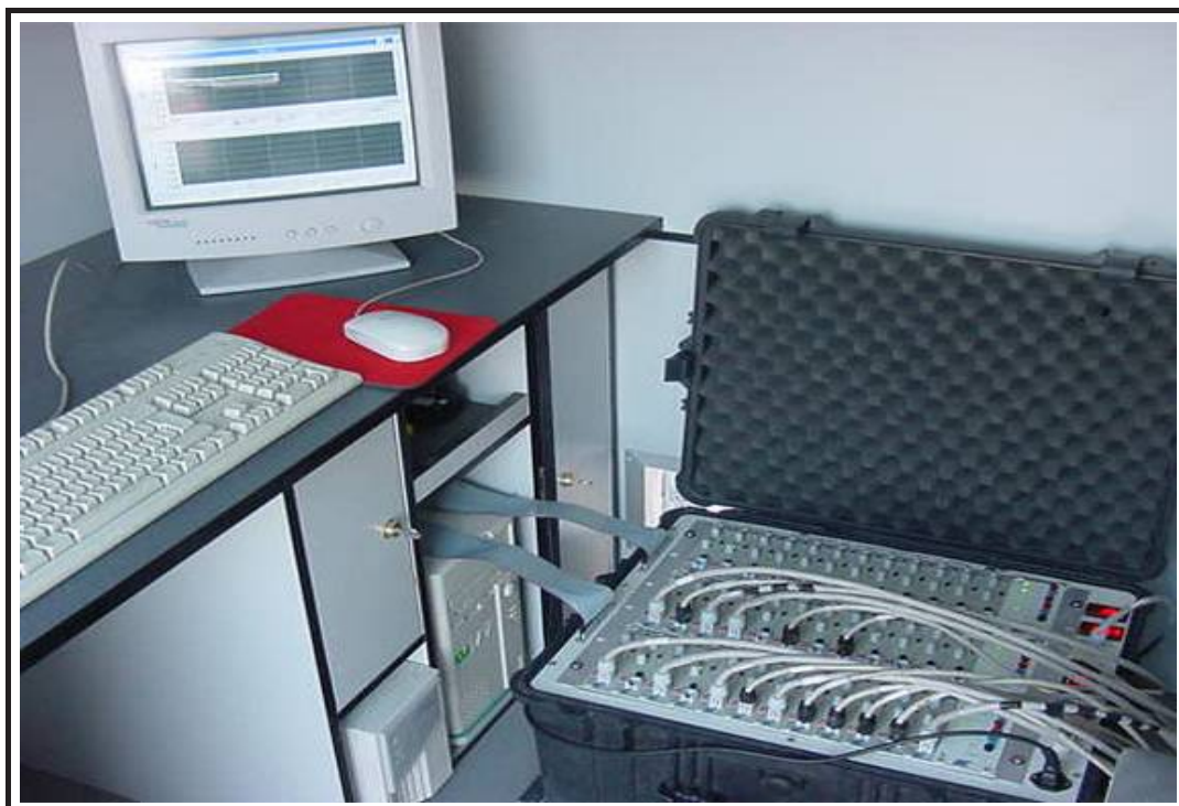
Foto 14: Vista general de acondicionadores de señal y equipo de adquisición
