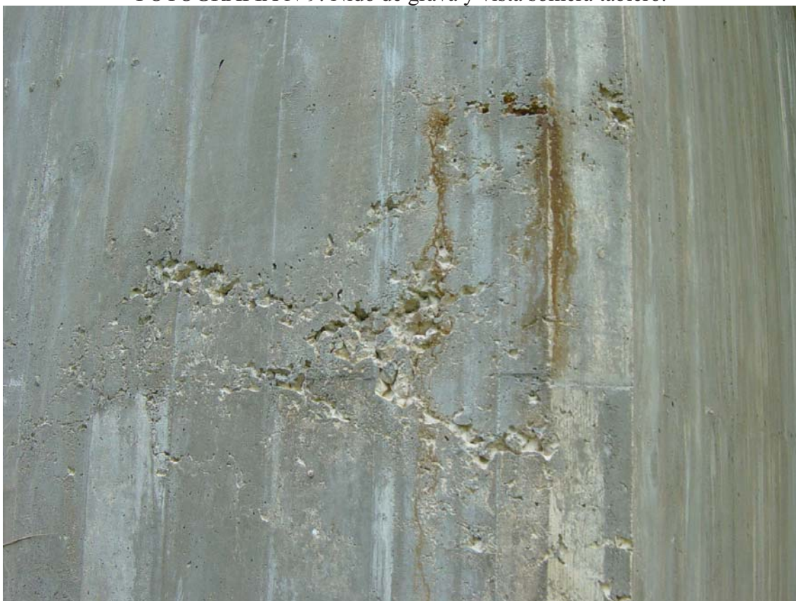
FOTOGRAFIA N°10: detalle nido de grava estribo.
