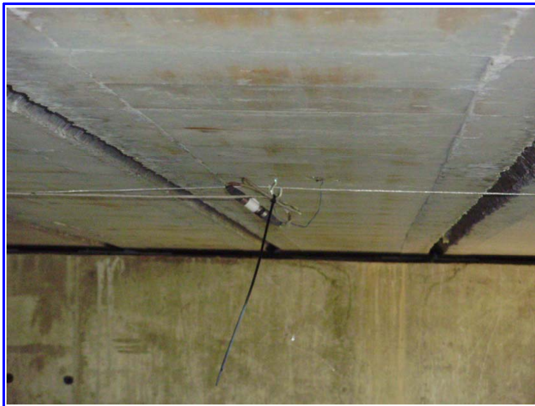
FOTOGRAFÍA N° 7: Detalle de galga extensométrica en centro de vano.
