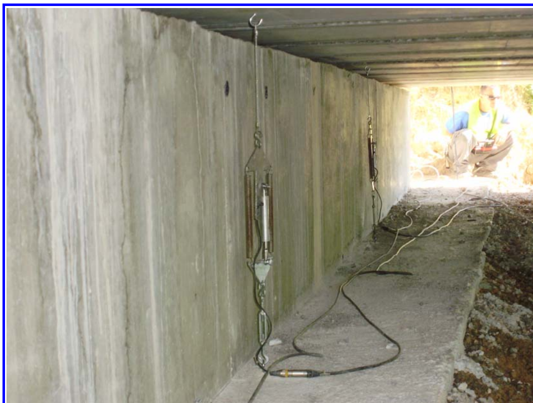
FOTOGRAFÍA N° 6: Detalle transductor desplazamiento en pila o estribo.
