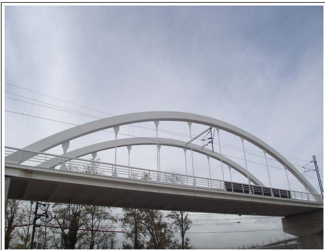
FOTOGRAFÍA N° 5: Tablero visto desde lado izquierdo.
