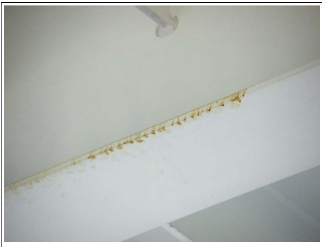
FOTOGRAFÍA N° 12: Manchas de óxido en la arista inferior dorsal de la vigueta 12 del tablero.
