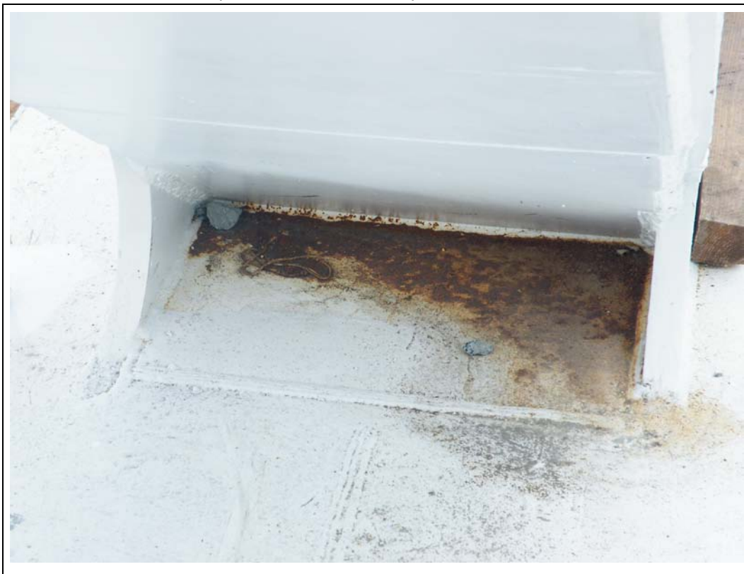
FOTOGRAFÍA Nº 15: Oxidaciones en la junta del arco izquierdo con el tablero en su parte frontal, cara superior de éste último.
