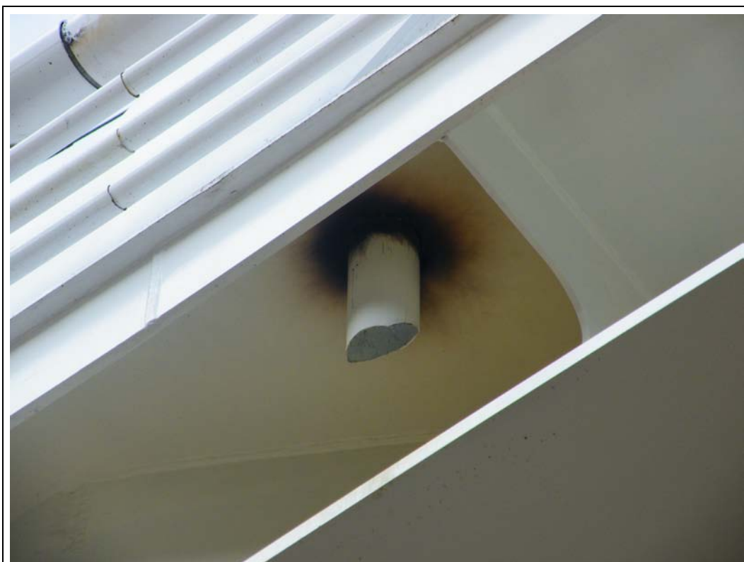
FOTOGRAFÍA Nº 14: Óxido alrededor del desagüe existente en el tirante izquierdo, a 1,00 m aproximadamente de la pila-estribo frontal.
