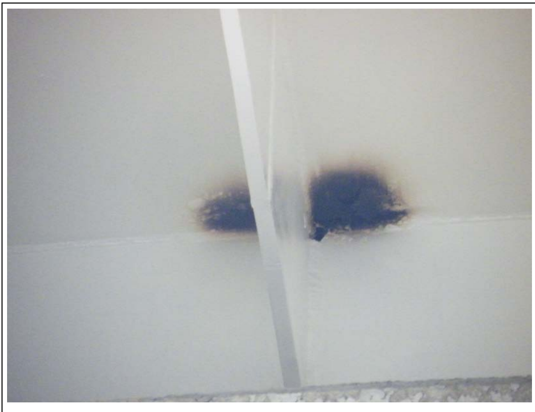
FOTOGRAFÍA N° 13: Oxidaciones junto a la vigueta 21 del tablero en el primer rigidizador de la derecha.
