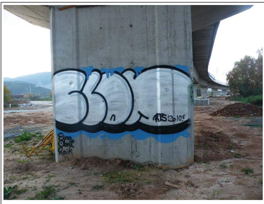
FOTOGRAFÍA N° 16: Pintadas tipo grafiti en los 2,00 m inferiores de la pila-estribo dorsal.
