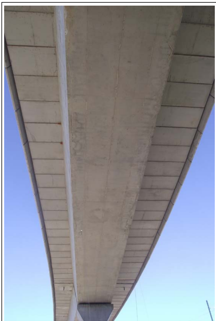
FOTOGRAFÍA Nº 53: Fibra inferior del Tramo XVI.
