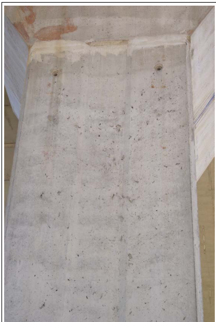
FOTOGRAFÍA Nº 87: Coqueras generalizadas en el paramento de la pila 16 en el tramo XVI.
