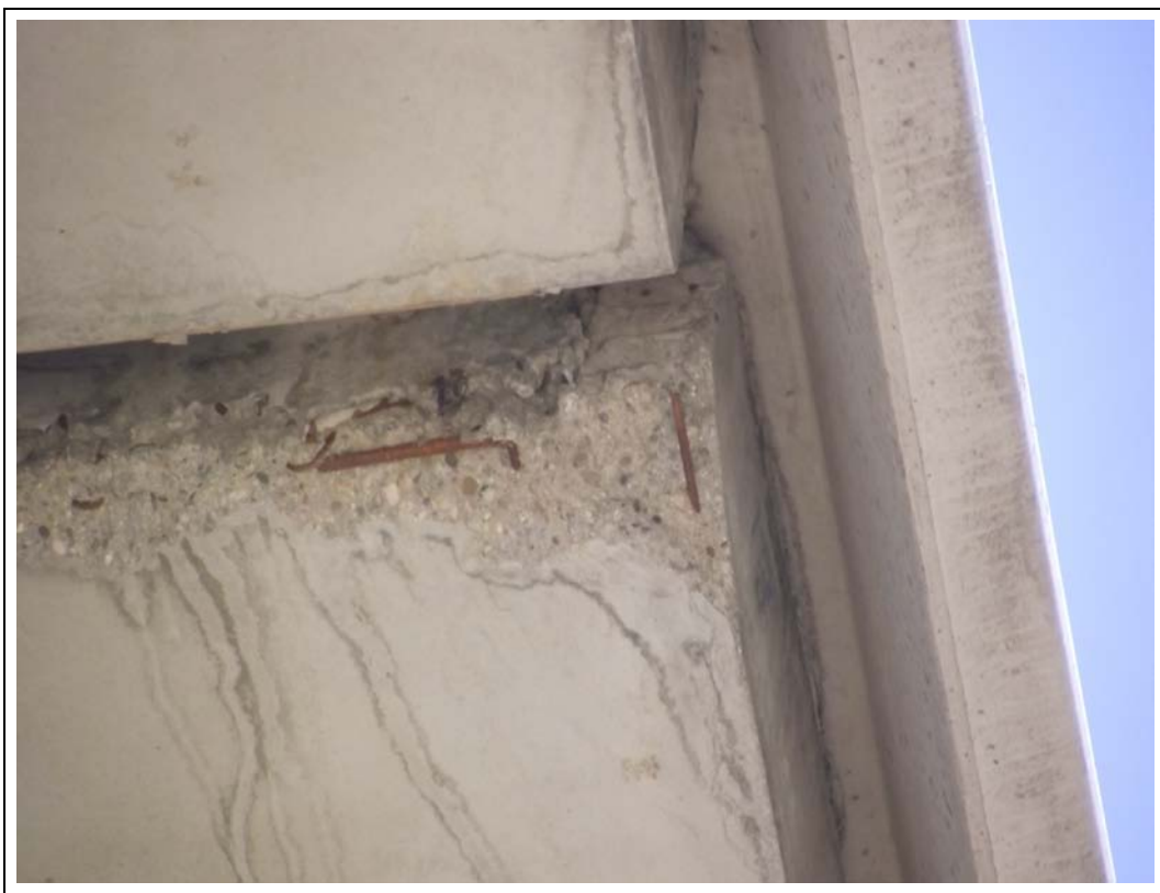
FOTOGRAFÍA Nº 85: Armaduras vistas en la junta entre tableros sobre la pila 13 en el lateral derecho del tramo XIII.
