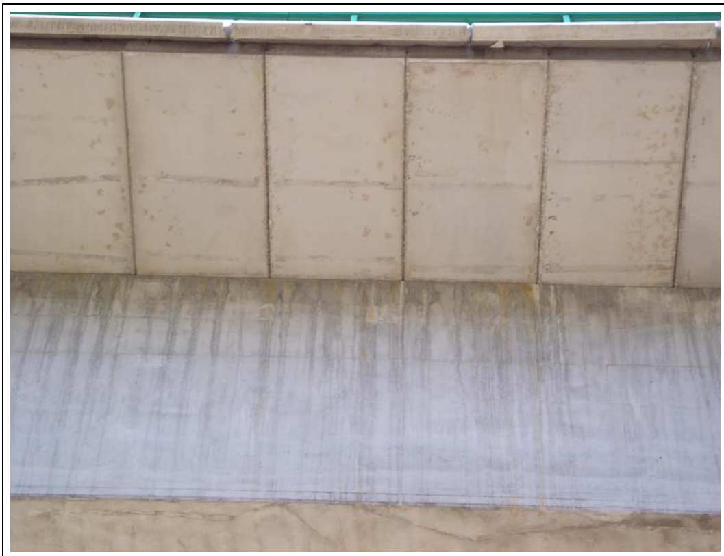
FOTOGRAFÍA Nº 86: Ecurridos terrosos y de humedad en el lateral derecho del tablero en el tramo X.
