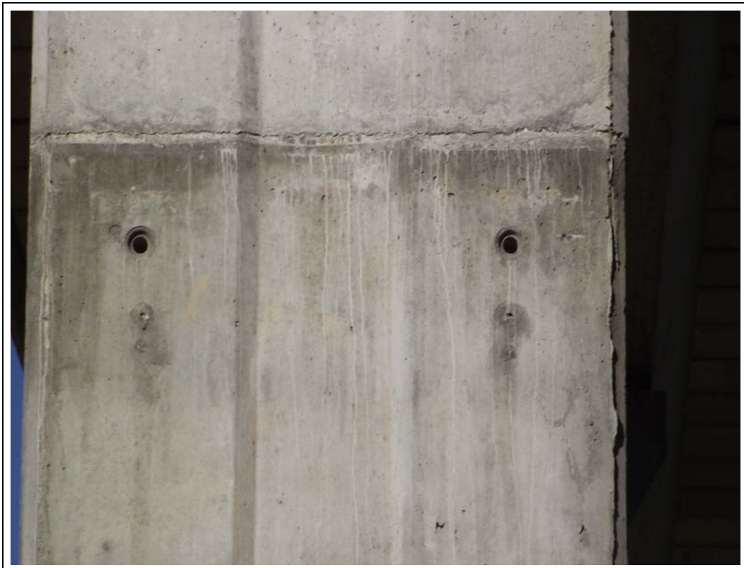
FOTOGRAFÍA N° 89: Ennegrecidos y escurrido de lechada en junta de hormigonado horizontal existente a mitad de la altura de la pila 6 en el tramo VII.
