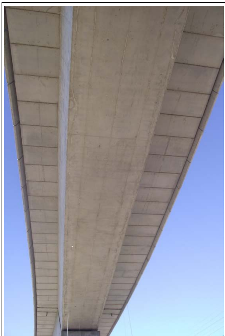
FOTOGRAFÍA Nº 47: Fibra inferior del Tramo XIV.
