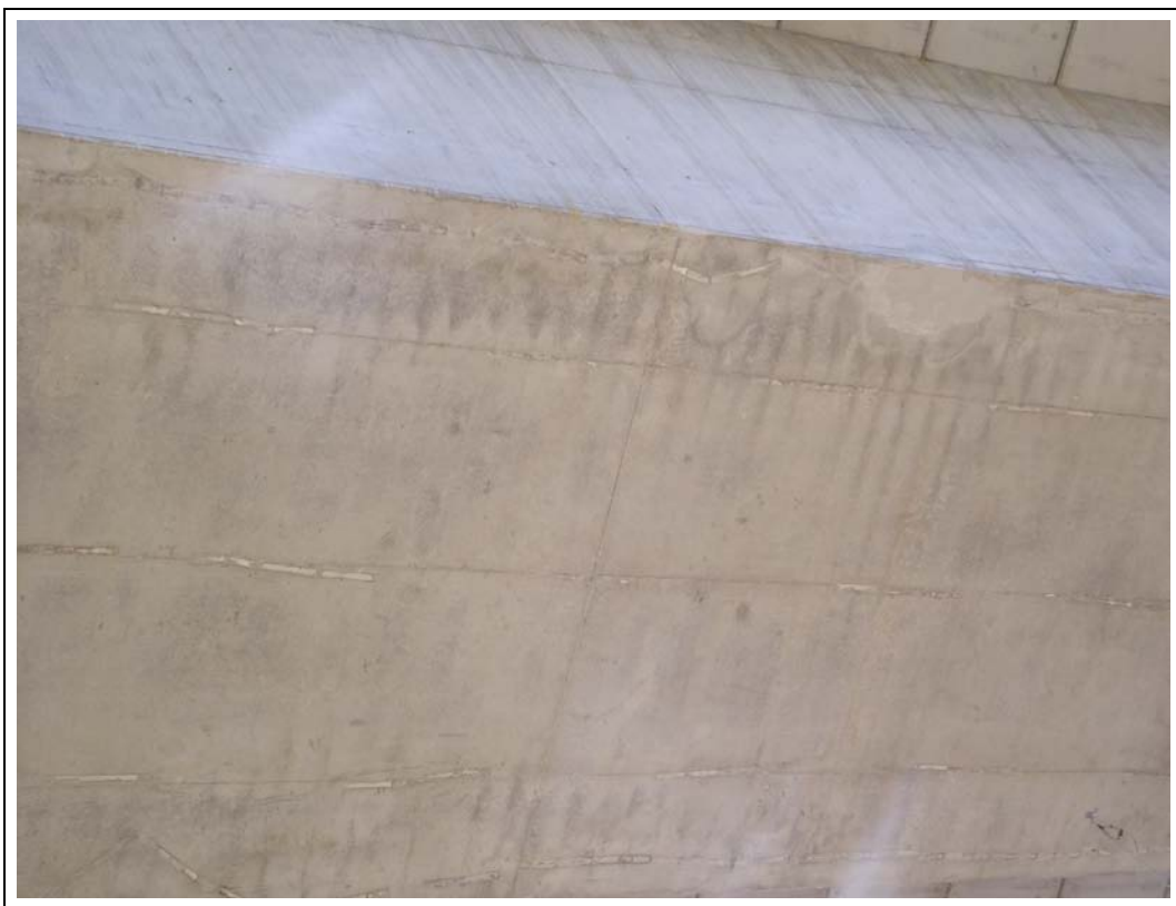
FOTOGRAFÍA N° 88: Manchas de humedad en el lado derecho de la fibra inferior del tablero en el tramo XII.
