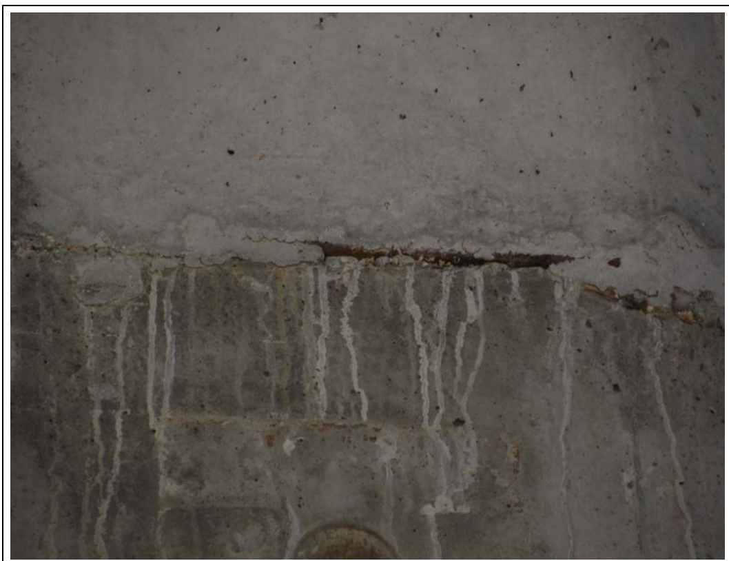
FOTOGRAFÍA Nº 90: Falta de sellado en la junta de hormigonado central de la pila 6 en tramo VI, con escurridos a través de la misma.
