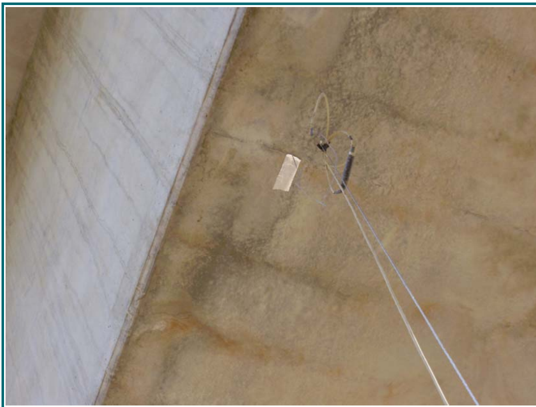
FOTOGRAFÍA N° 7: Detalle de galga extensométrica en centro de vano.
