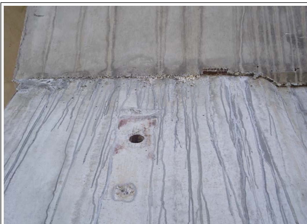
FOTOGRAFÍA Nº 61: Armadura vista y oxidada en la junta de hormigonado con el capitel en el lateral izquierdo de pila 2.
