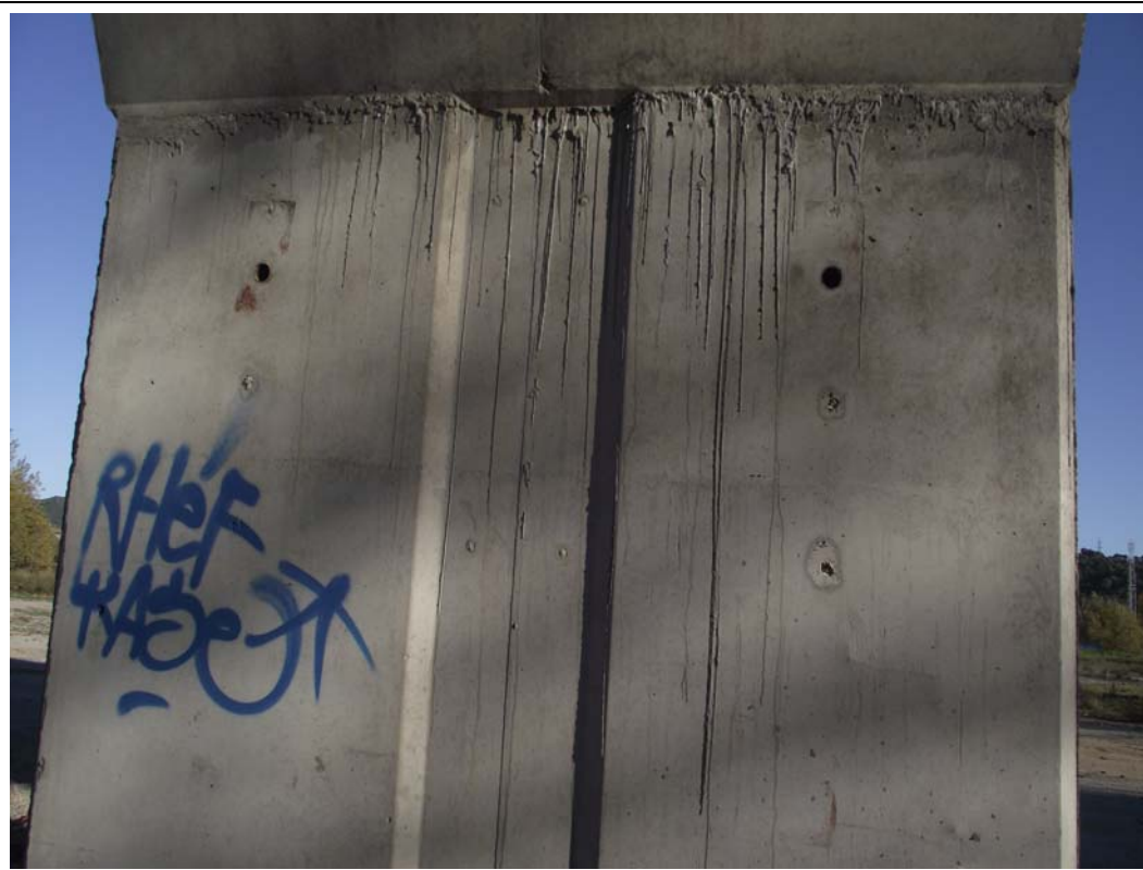
FOTOGRAFÍA N° 62: Pintadas y escurridos de lechada en lateral derecho de pila 3.
