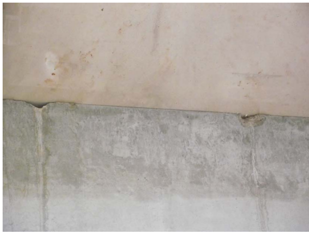
FOTOGRAFÍA N° 74: Meteorizaciones en unión alma-voladizo en lateral izquierdo de tramo V.
