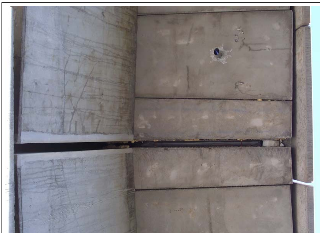
FOTOGRAFÍA Nº 71: Armadura vista en junta unión de las losas 2 y 3 sobre el lateral derecho de la pila 2.
