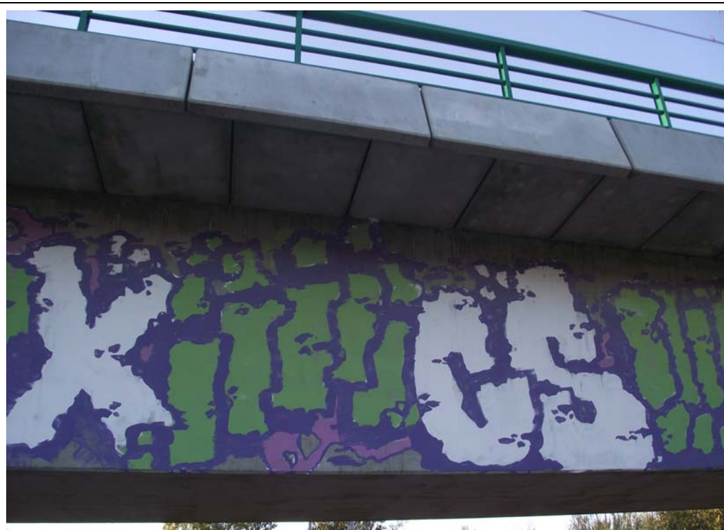
FOTOGRAFÍA N° 79: Pintadas tipo grafiti en el alma izquierda de la viga del tramo X.
