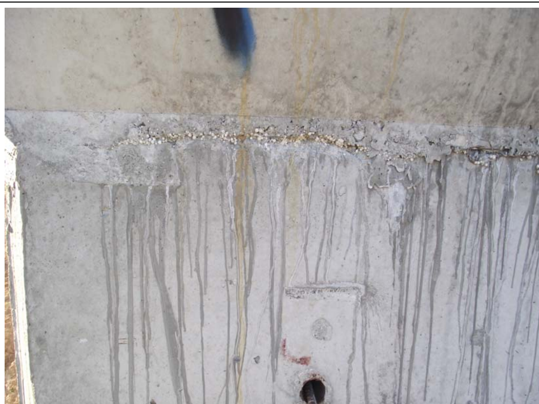
FOTOGRAFÍA N° 69: Junta de hormigonado mal sellada con porexpan visto en lateral izquierdo de pila 8.
