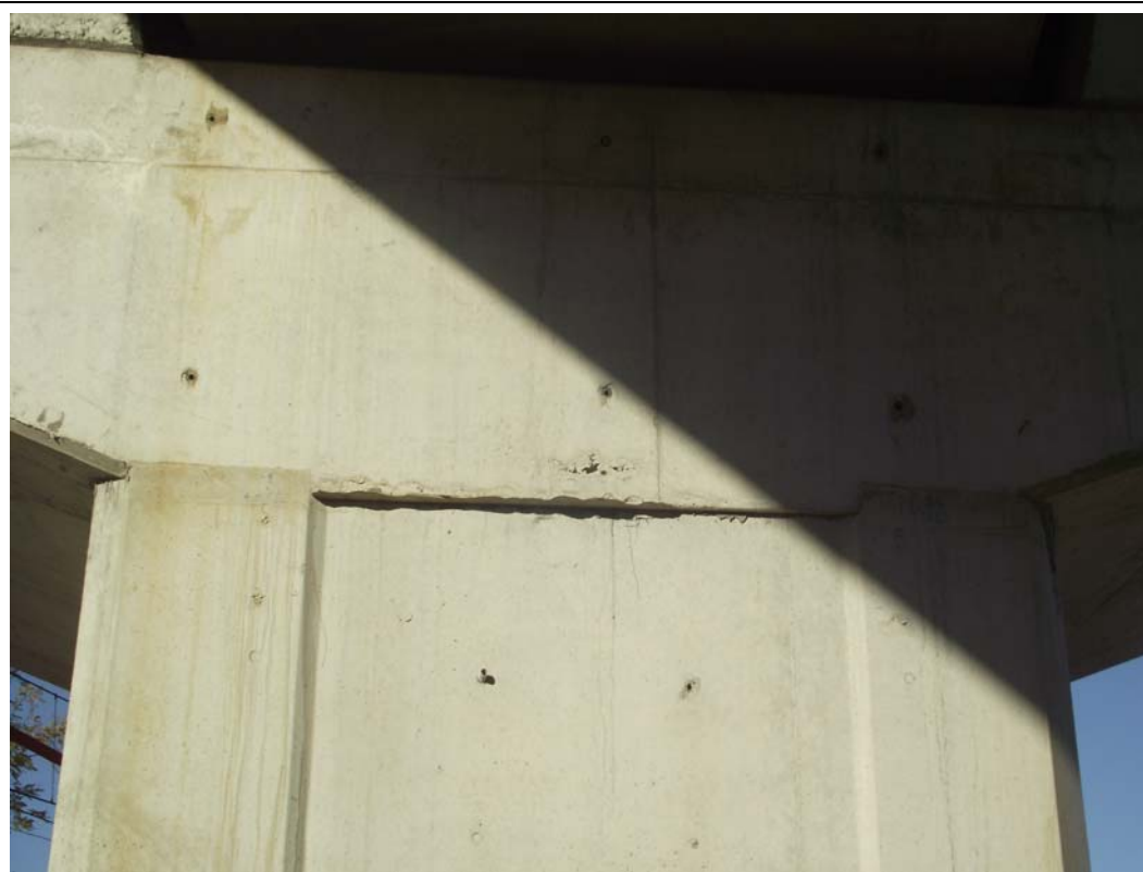
FOTOGRAFÍA N° 54: Escurridos terrosos bajo los apoyos en el paramento de la pila-estribo de entrada en el vano I.
