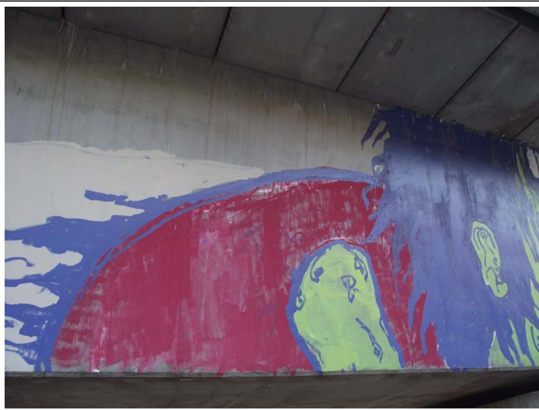
FOTOGRAFÍA N° 80: Pintadas tipo grafiti en alma izquierda de la viga del tramo XI.
