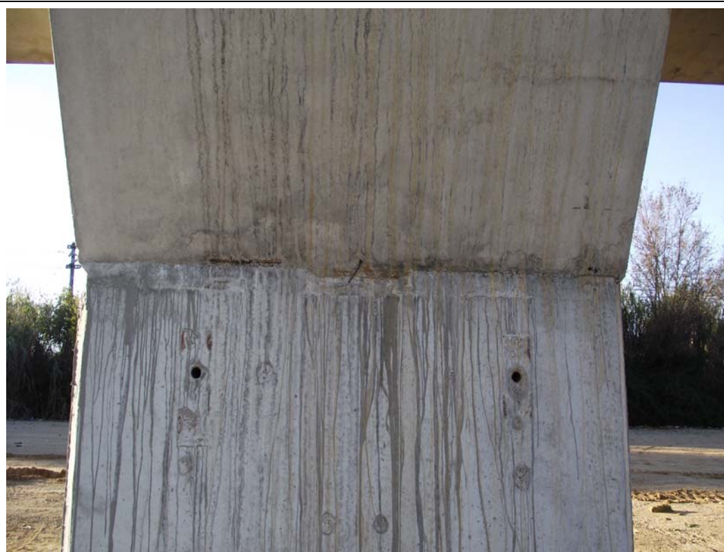
FOTOGRAFÍA N° 68: Escurridos de lechada y armadura vista y oxidada en junta de hormigonado con capitel en lateral izquierdo de pila 7.
