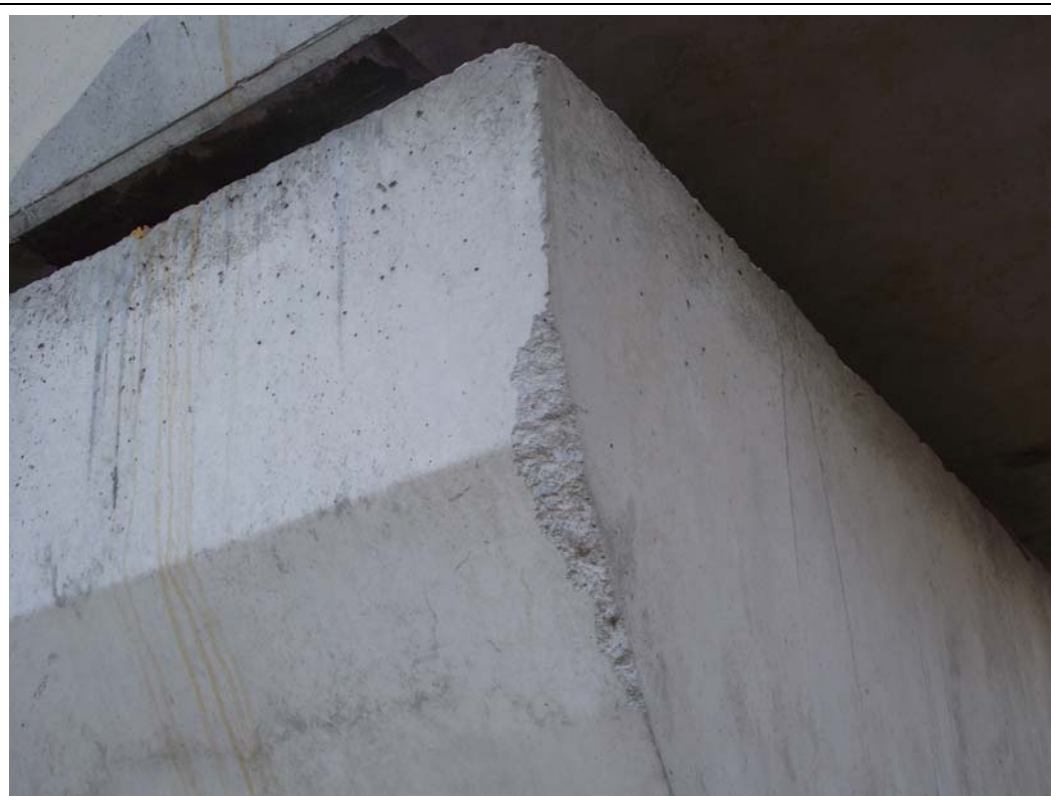
FOTOGRAFÍA Nº 70: Desconchón en arista del capitel del frente de la pila 9 en tramo IX con lateral izquierdo.
