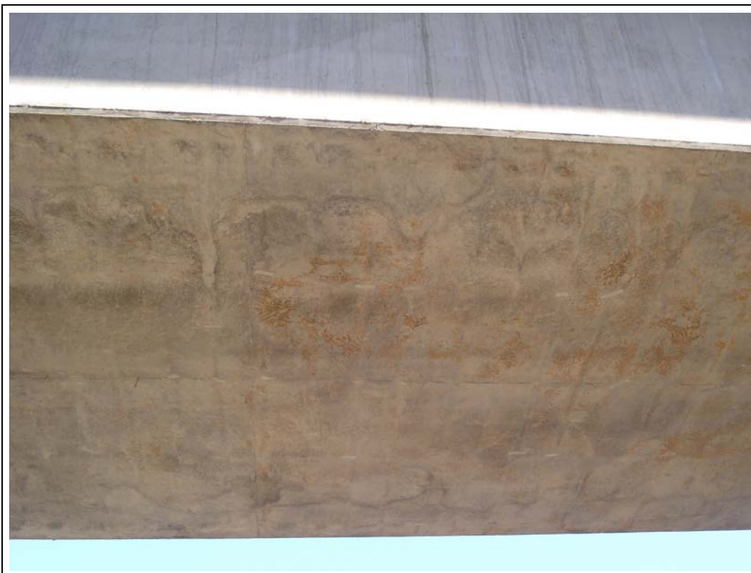
FOTOGRAFÍA N° 76: Manchas terrosas y humedades en fibra inferior de tramo VI.
