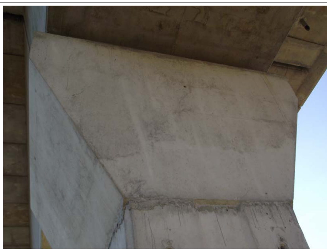
FOTOGRAFÍA N° 65: Ennegrecidos en capitel de frente de pila 5 en tramo V y lateral derecho.
