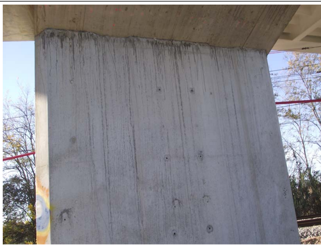
FOTOGRAFÍA N° 55: Escurridos de lechada en el lateral izquierdo de la pila-estribo de entrada desde la junta de hormigonado con el capitel.
