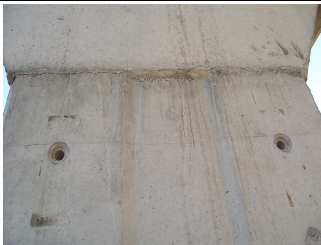
FOTOGRAFÍA N° 64: Ecurridos terrosos en el frente de la pila 4 en tramo IV.
