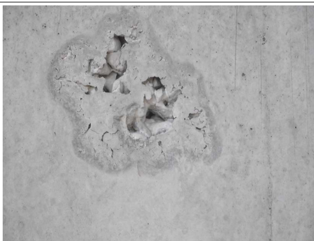
FOTOGRAFÍA N° 63: Segregaciones del hormigón en paramento de pila 3 en vano III.
