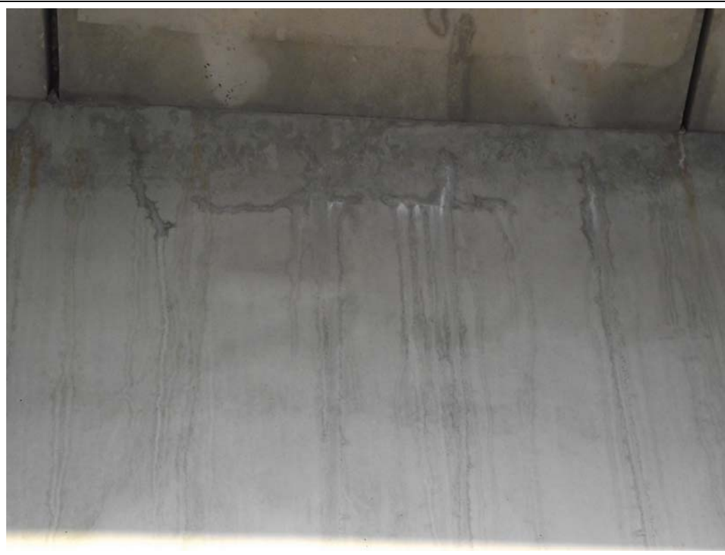
FOTOGRAFÍA N° 78: Ecurridos terrosos y de humedad con eflorescencias en alma derecha de la viga del tramo X.
