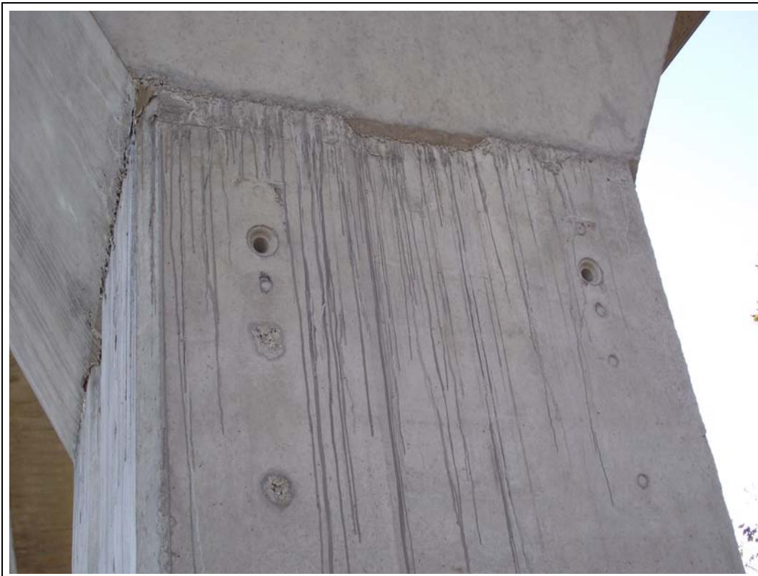
FOTOGRAFÍA Nº 60: Ecurridos de lechada en paramento de pila 2 en tramo II.
