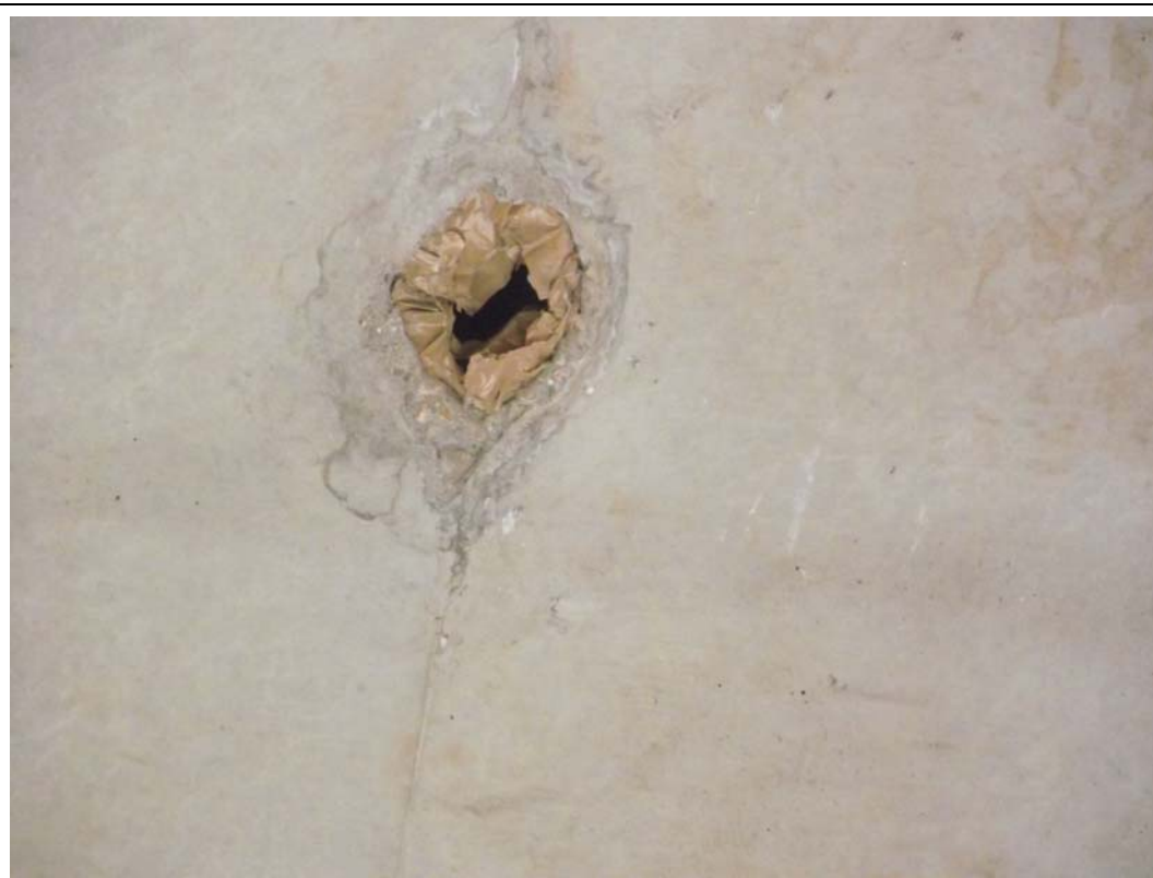
FOTOGRAFÍA N° 72: Agujero acompañado de eflorescencias en la junta longitudinal que recorre la fibra inferior de Tramo IV.
