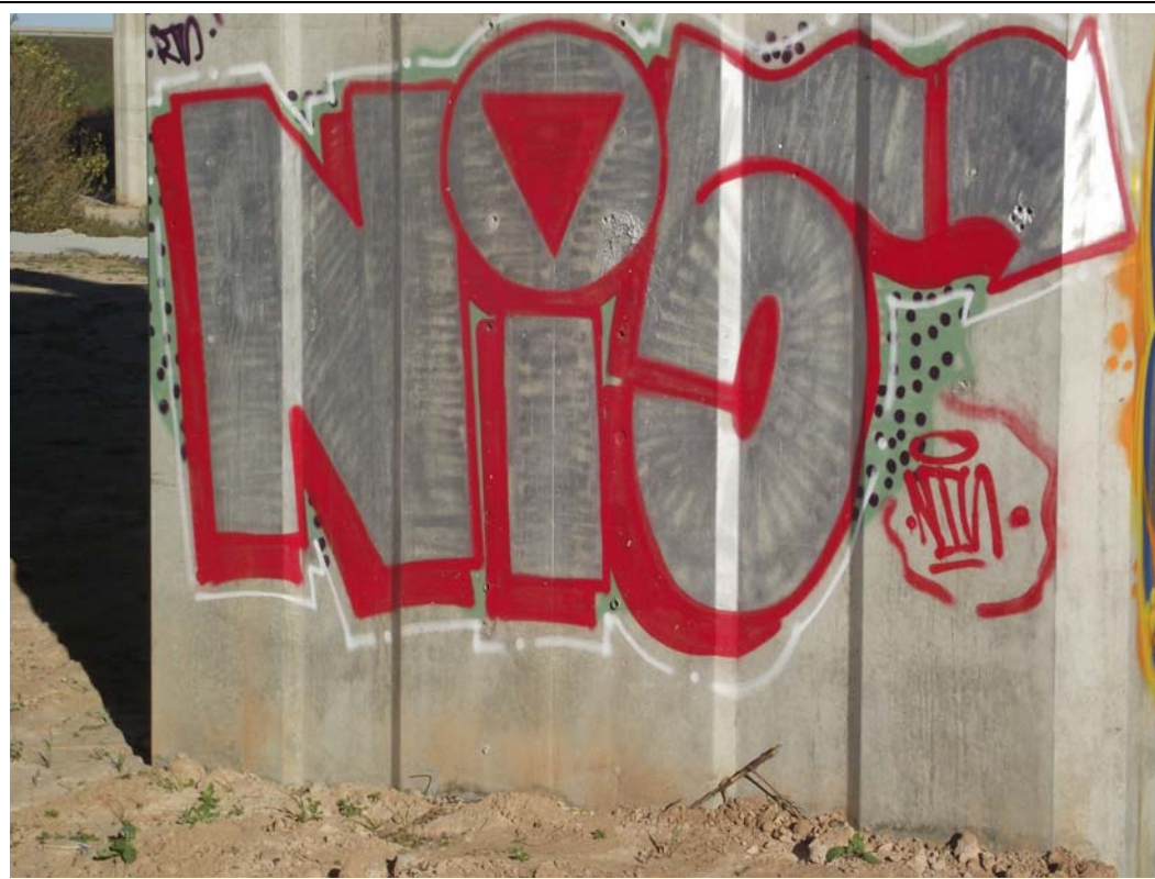
FOTOGRAFÍA N° 56: Pintadas tipo grafiti en mitad inferior del lateral izquierdo de pila-estribo de entrada.
