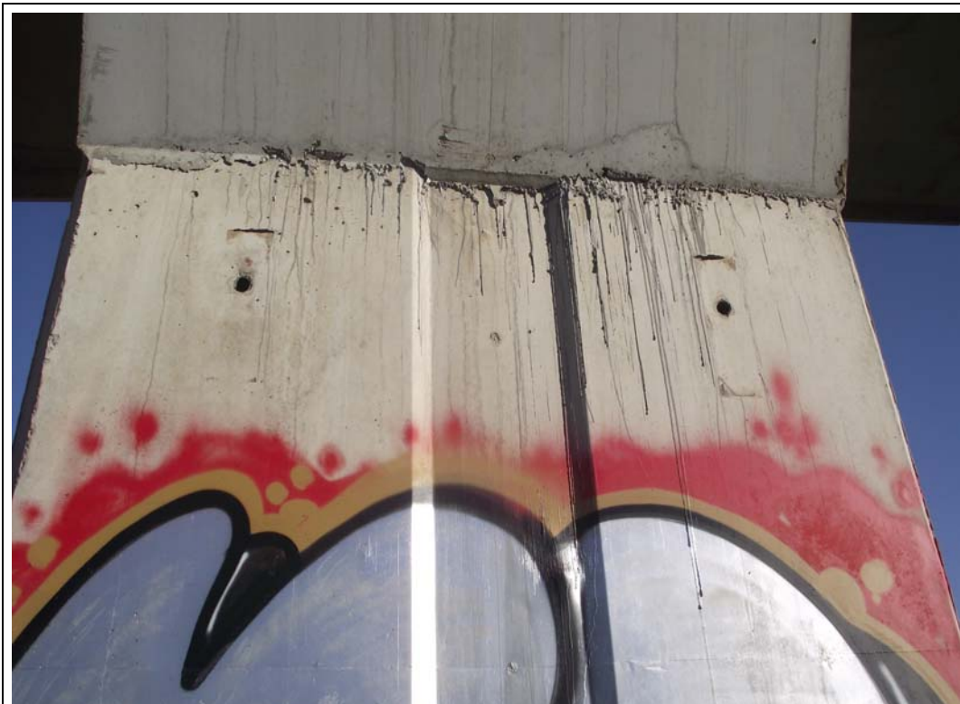
FOTOGRAFÍA N° 58: Ecurridos de lechada en junta de hormigonado con capitel de lateral derecho de pila 1.
