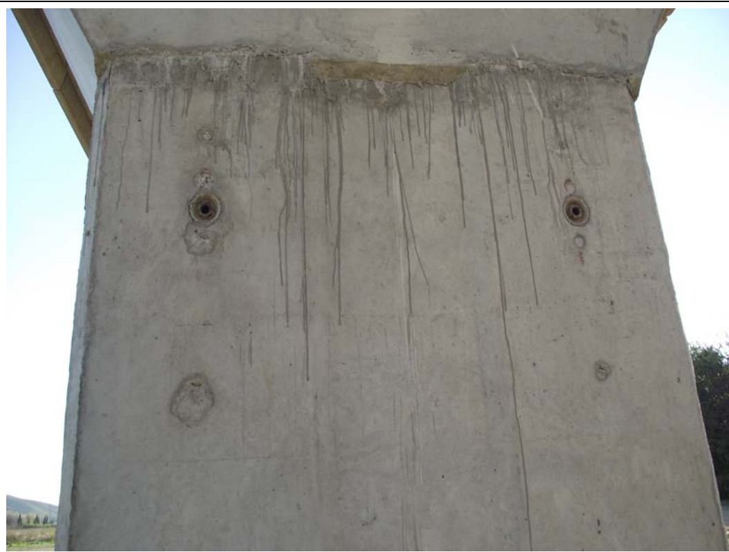
FOTOGRAFÍA N° 66: Escurridos de lechada en frente de pila 6 en tramo VI y desagües mal terminados.
