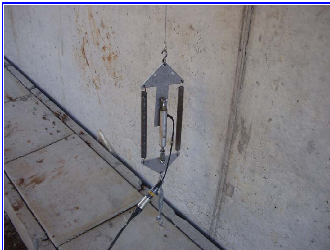
FOTOGRAFÍA N° 6: Detalle transductor desplazamiento en pila o estribo.
