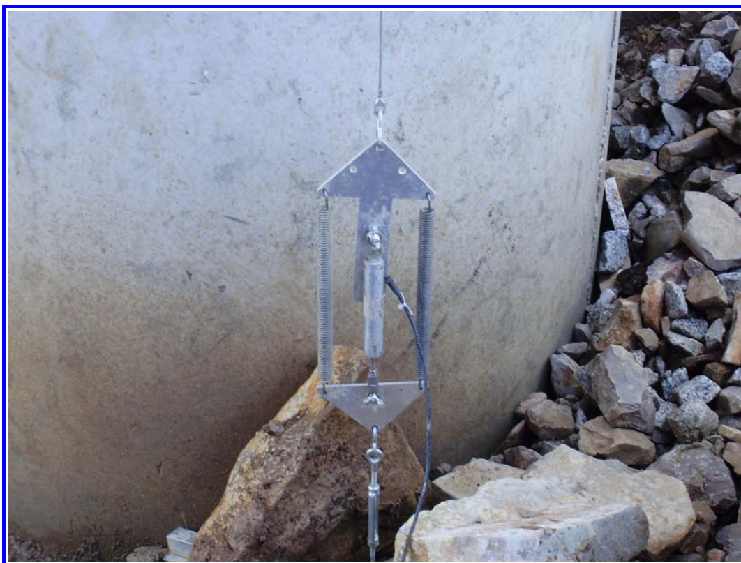
FOTOGRAFÍA N° 6: Detalle transductor desplazamiento en pila o estribo.
