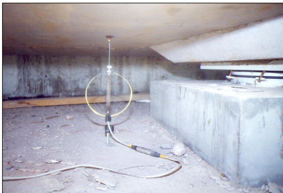
Nº 2.- Instrumentación mediante aros extensométricos en el estribo 2.
