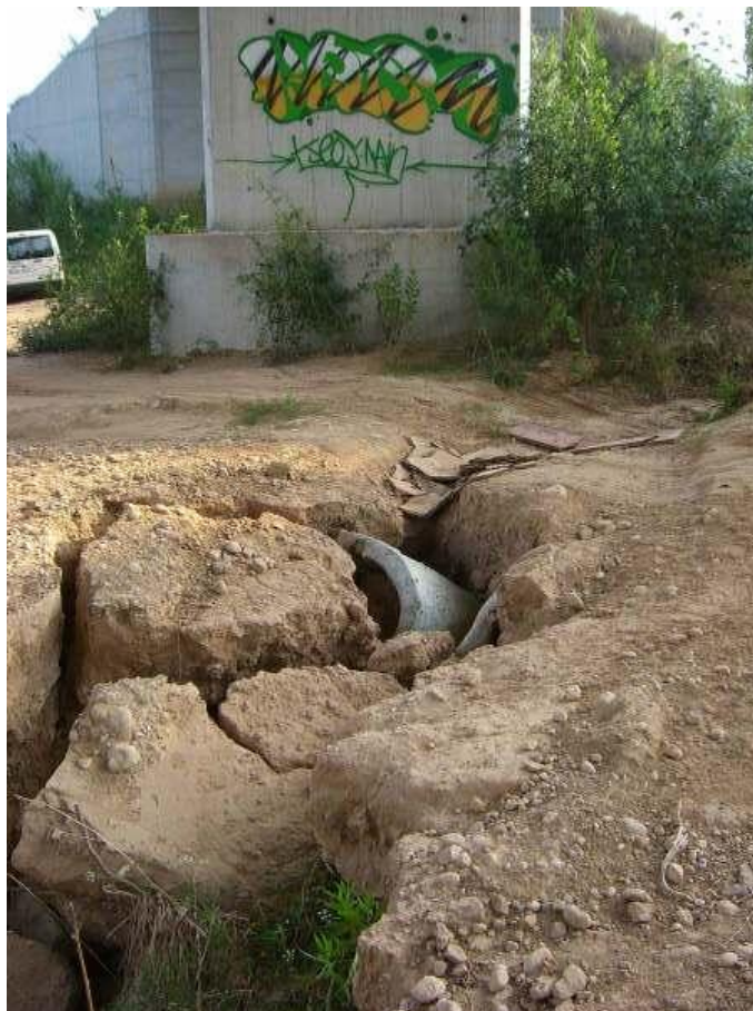
FOTOGRAFÍA Nº 2: CARCABA DEL DRENAJE DEL ESTRIBO DERECHO AGUAS ARRIBA
