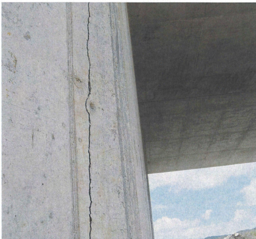
Foto 11: Detalle grieta en aleta
