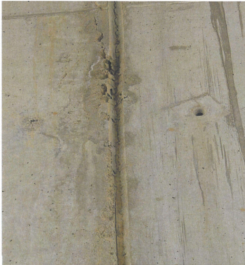
Foto 13:Detalle daños junta transversal marcos
