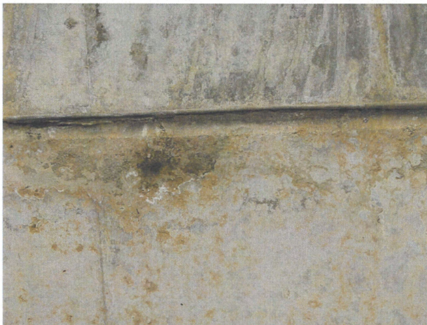
Foto 12: Detalle humedades en junta longitudinal entre módulos de los marcos.
