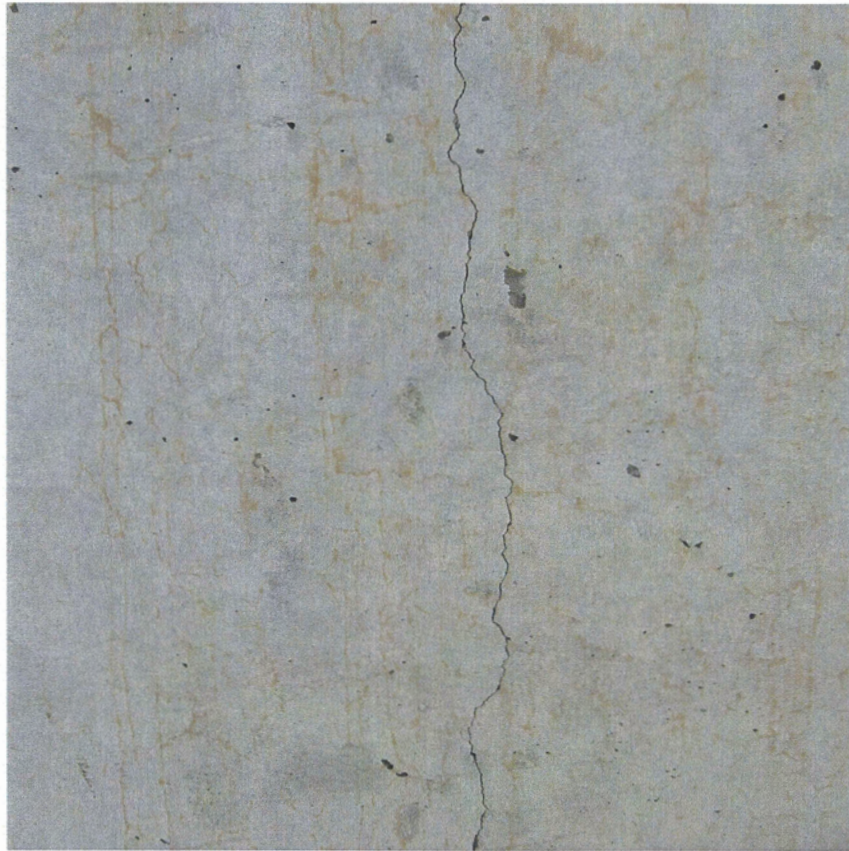
Foto 9: Detalle fisura en aleta
