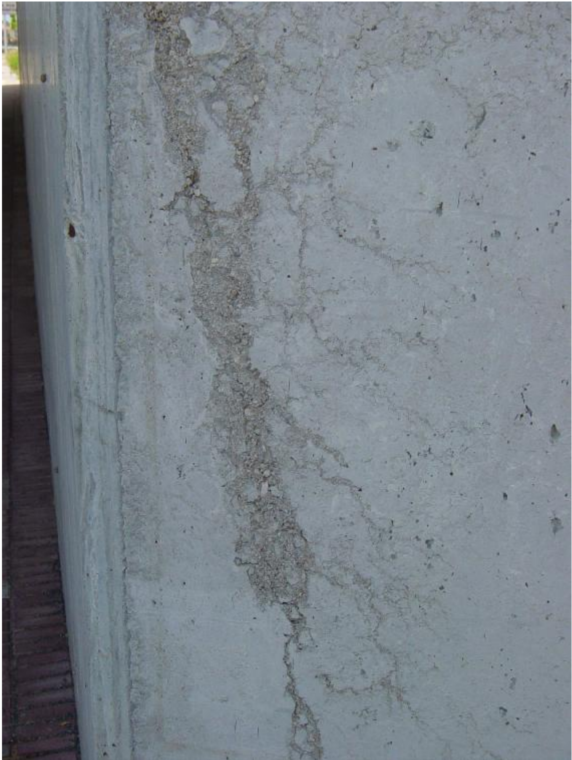
FOTOGRAFÍA N°8: Detalle de nido de grava en la aleta.
