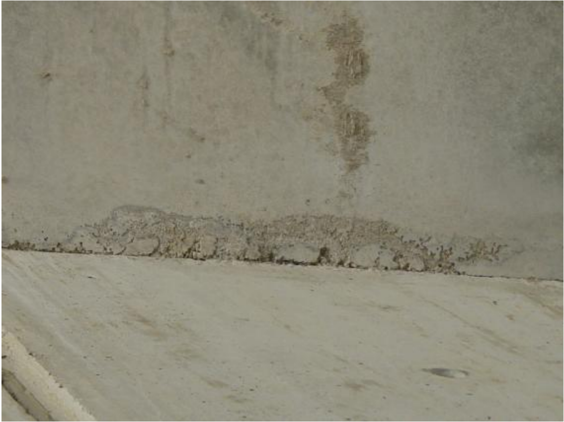
FOTOGRAFÍA N°11:Detalle de nido de grava en la losa
