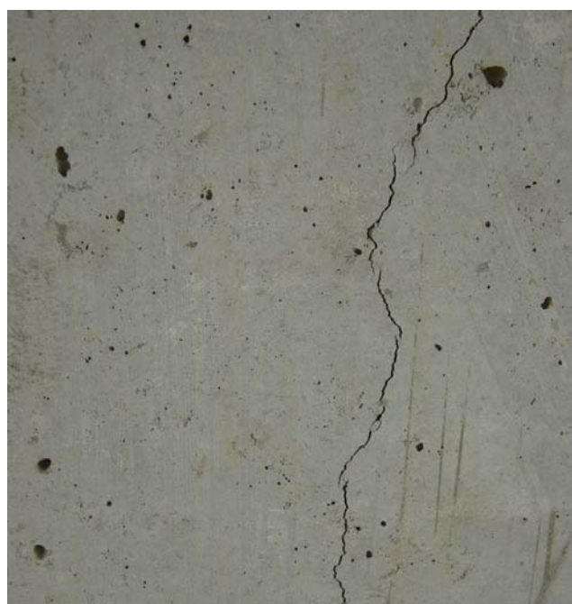
Foto 10: Detalle fisura en hastial de marco
