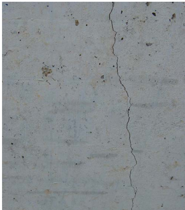
Foto 9: Detalle fisura en aleta
