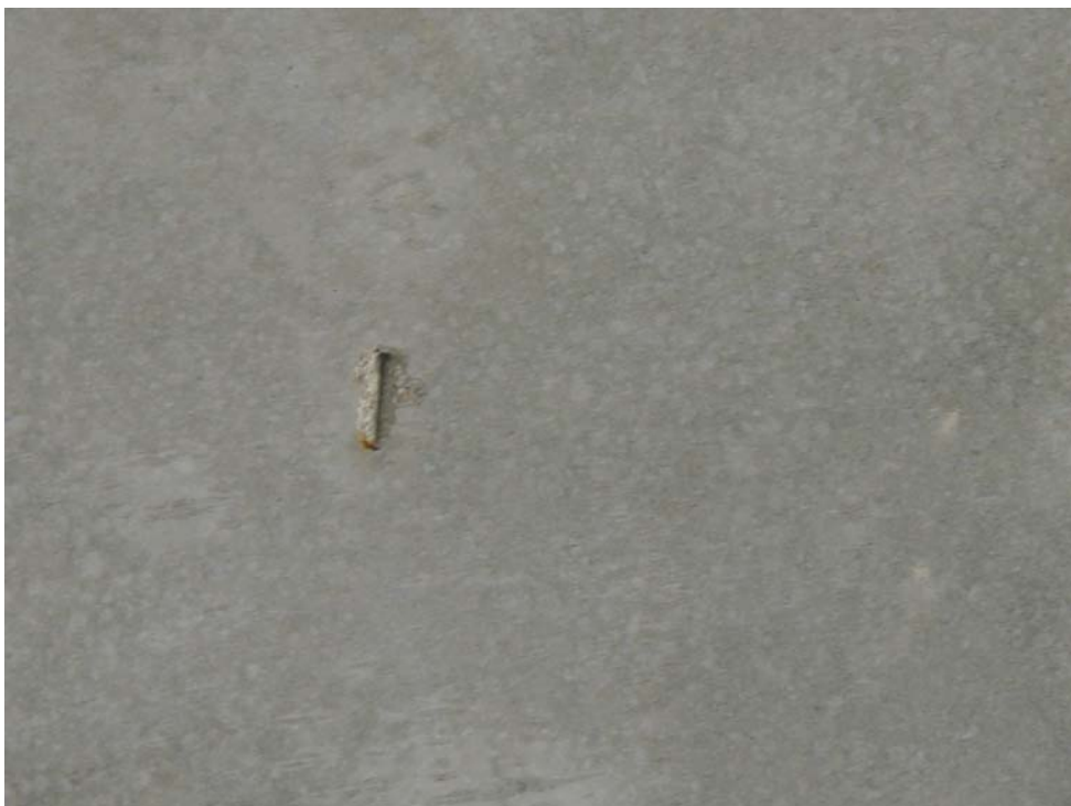
Foto 12: Detalle armadura vista somera en losa
