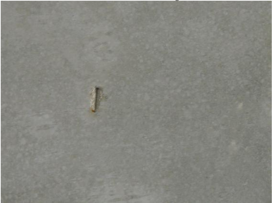
FOTOGRAFÍA N°12: Detalle armadura vista somera en losa.
