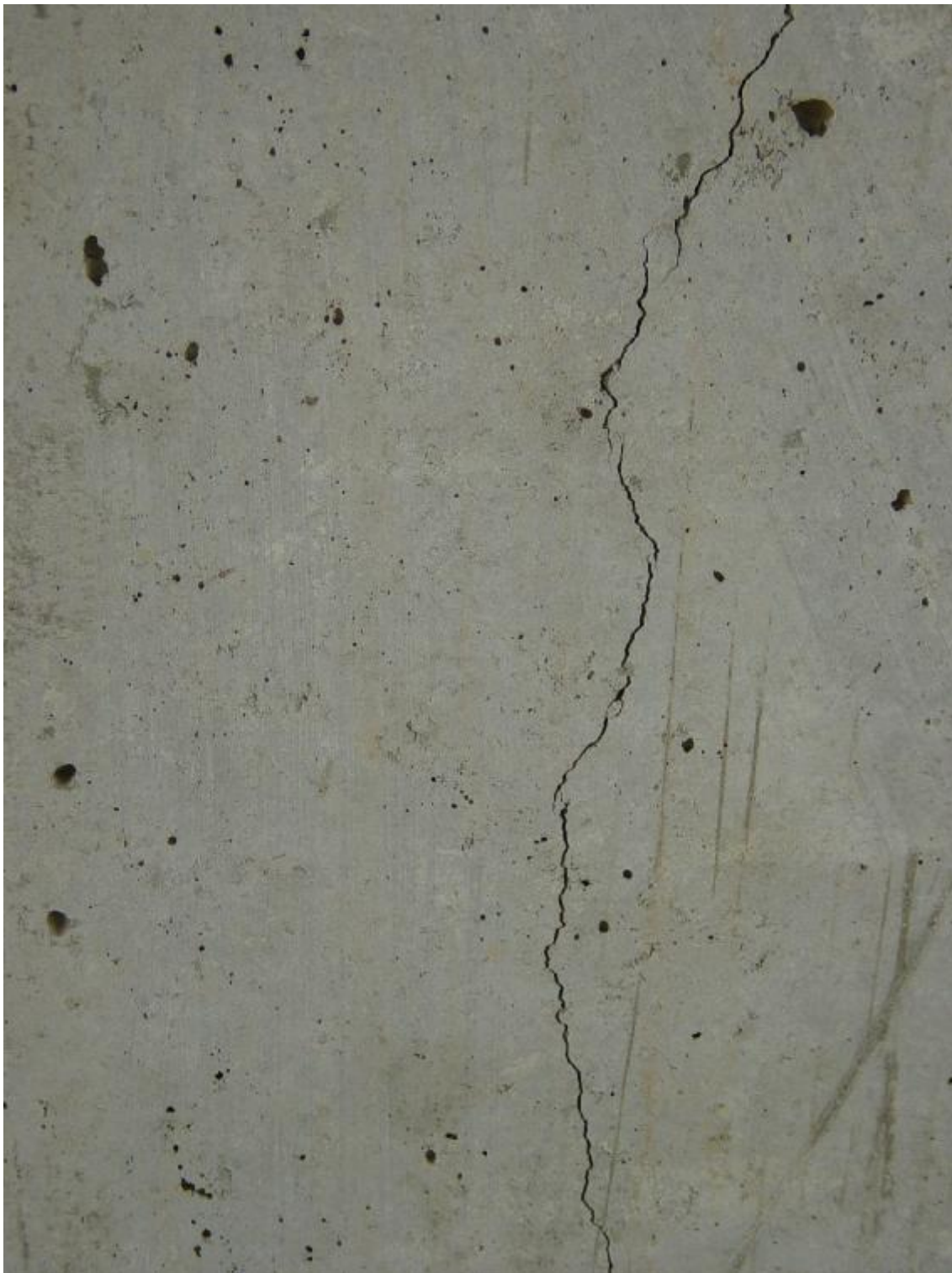
FOTOGRAFÍA N°10: Detalle fisura hastial marco.
