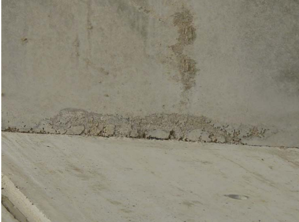
Foto 11: Detalle nidos de grava en losa
