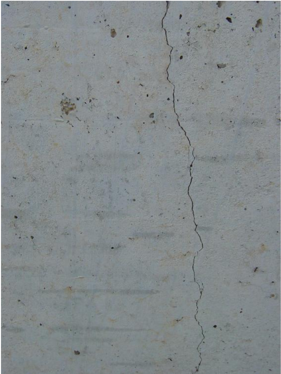
FOTOGRAFÍA N°9: Detalle fisura en la aleta.
