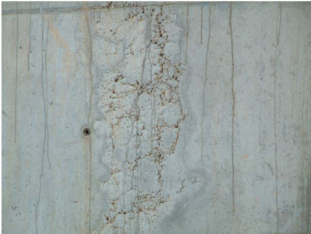
FOTOGRAFÍA N° 13: NIDO DE GRAVA EN ESTRIBO DE SALIDA
