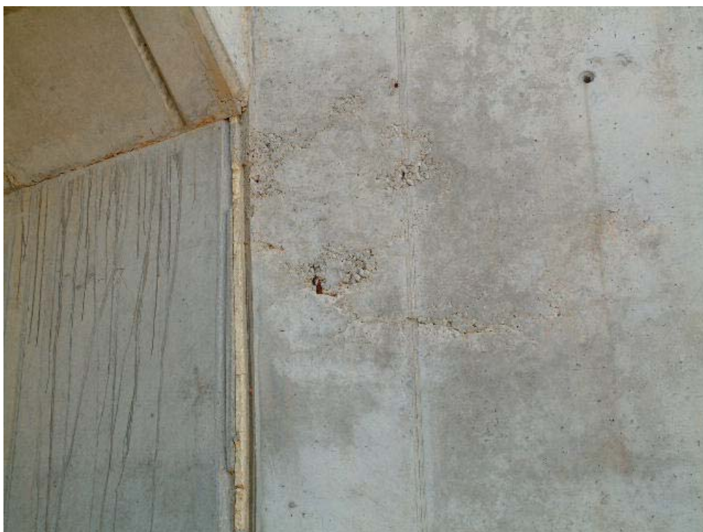
FOTOGRAFÍA N° 15: NIDO DE GRAVA EN ALETA SALIDA IZQ
