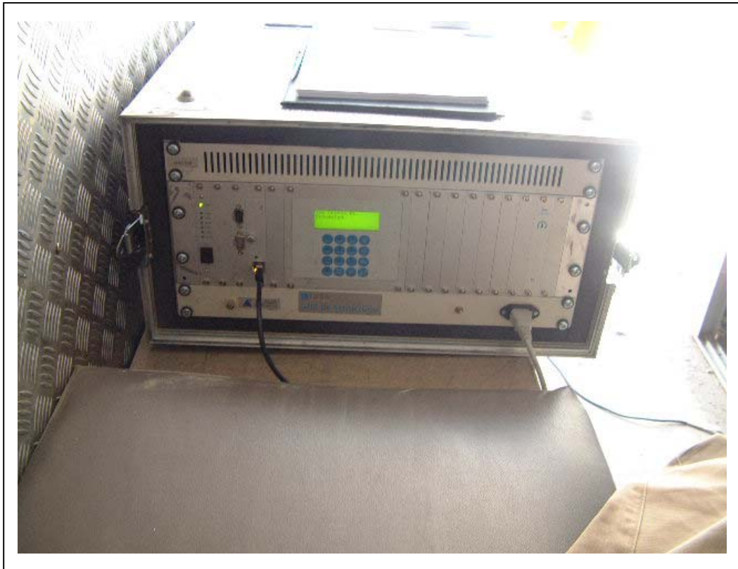
FOTOGRAFÍA 3: Equipos de adquisición de datos
