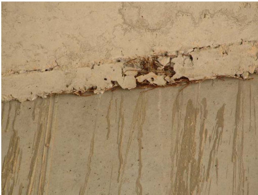
FOTOGRAFÍA Nº 12: DEFECTO UNION ESTRIBO-TABLERO
