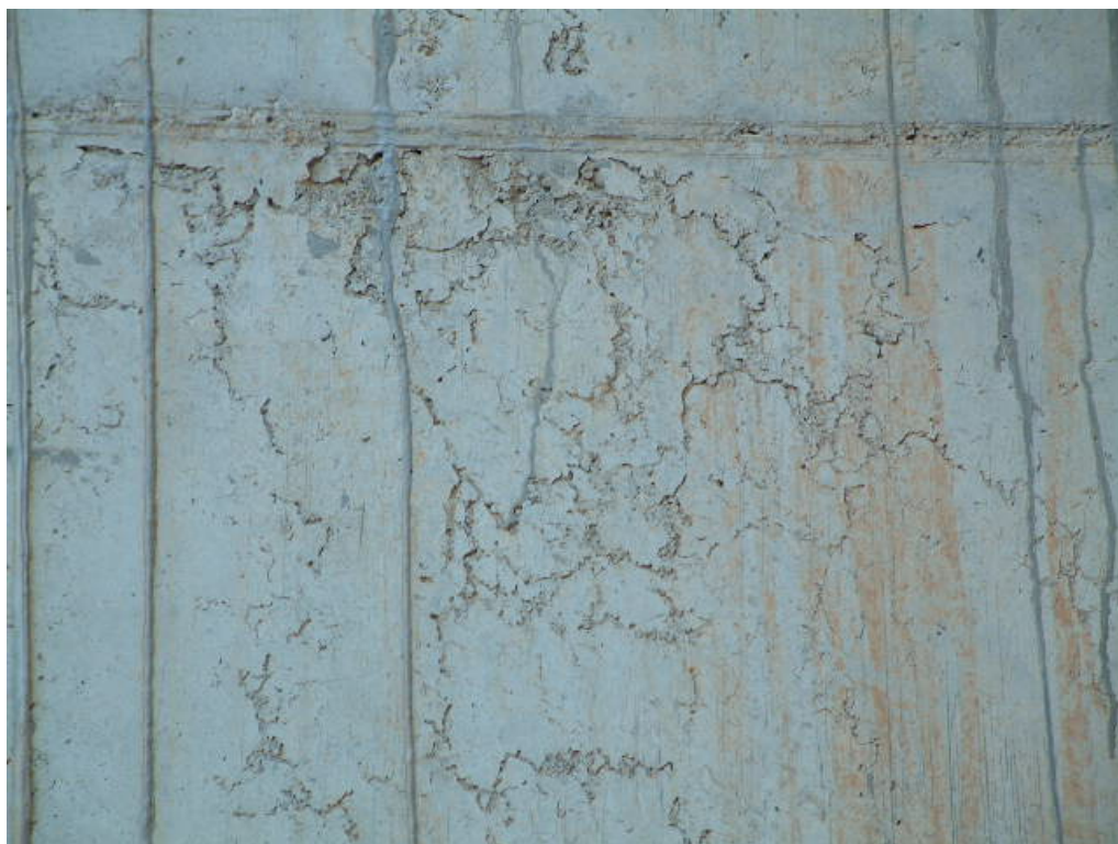
FOTOGRAFÍA N° 11: NIDO DE GRAVA EN ESTRIBO
