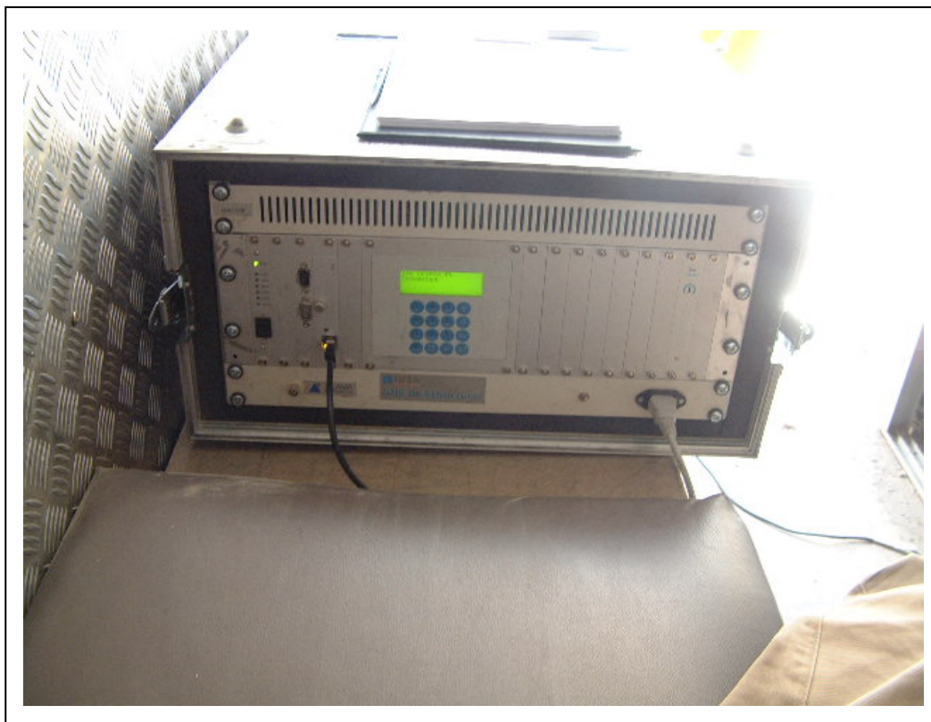
FOTOGRAFÍA 3: Equipos de adquisición de datos
