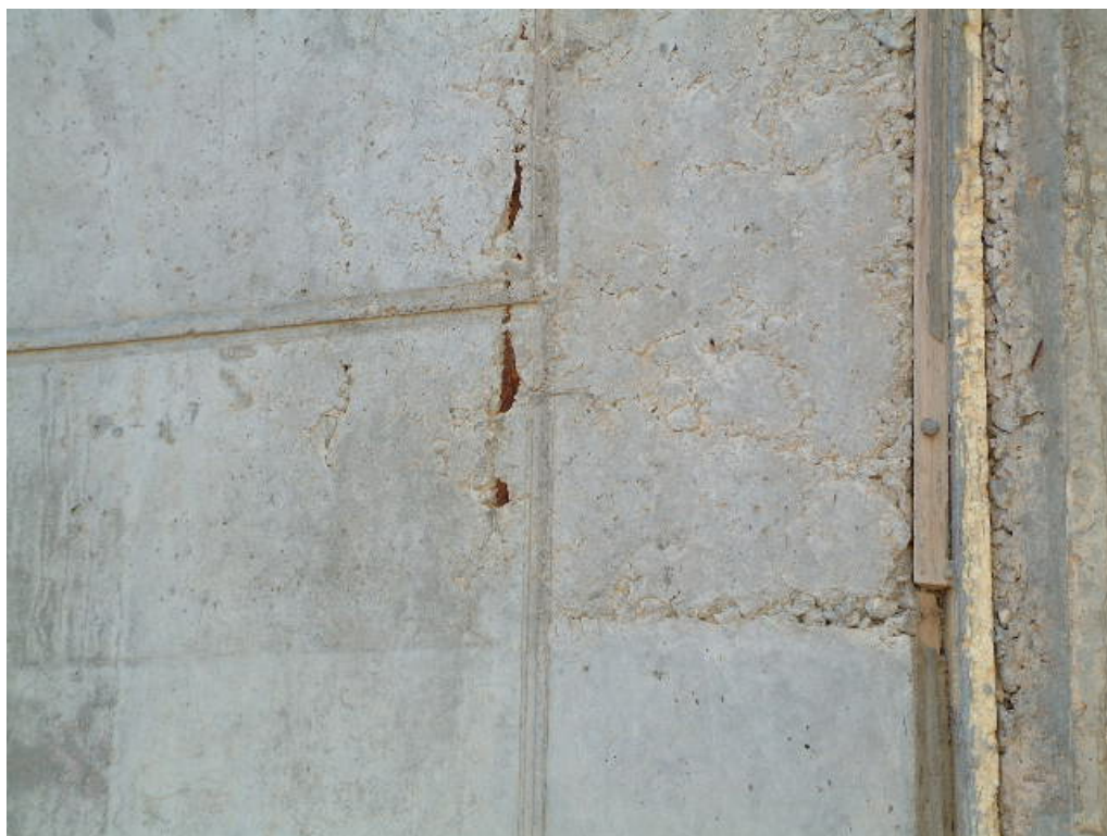
FOTOGRAFÍA N° 12: ARMADURA VISTA EN ALETA SALIDA IZQ
