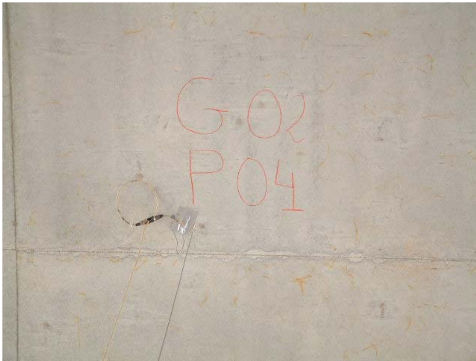
FOTOGRAFÍA 7: Banda extensométrica y flecha a L/2
