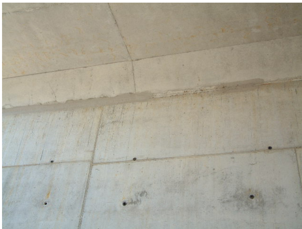
FOTOGRAFÍA N° 11: COQUERAS EN ESTRIBOS DE SALIDA
