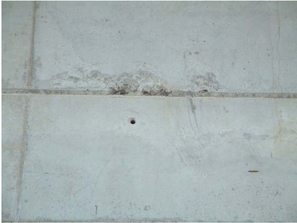
FOTOGRAFÍA N° 11: COQUERAS EN ESTRIBOS DE SALIDA
