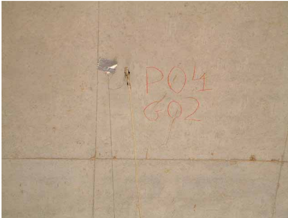
FOTOGRAFÍA 7: Banda extensométrica y flecha a L/2
