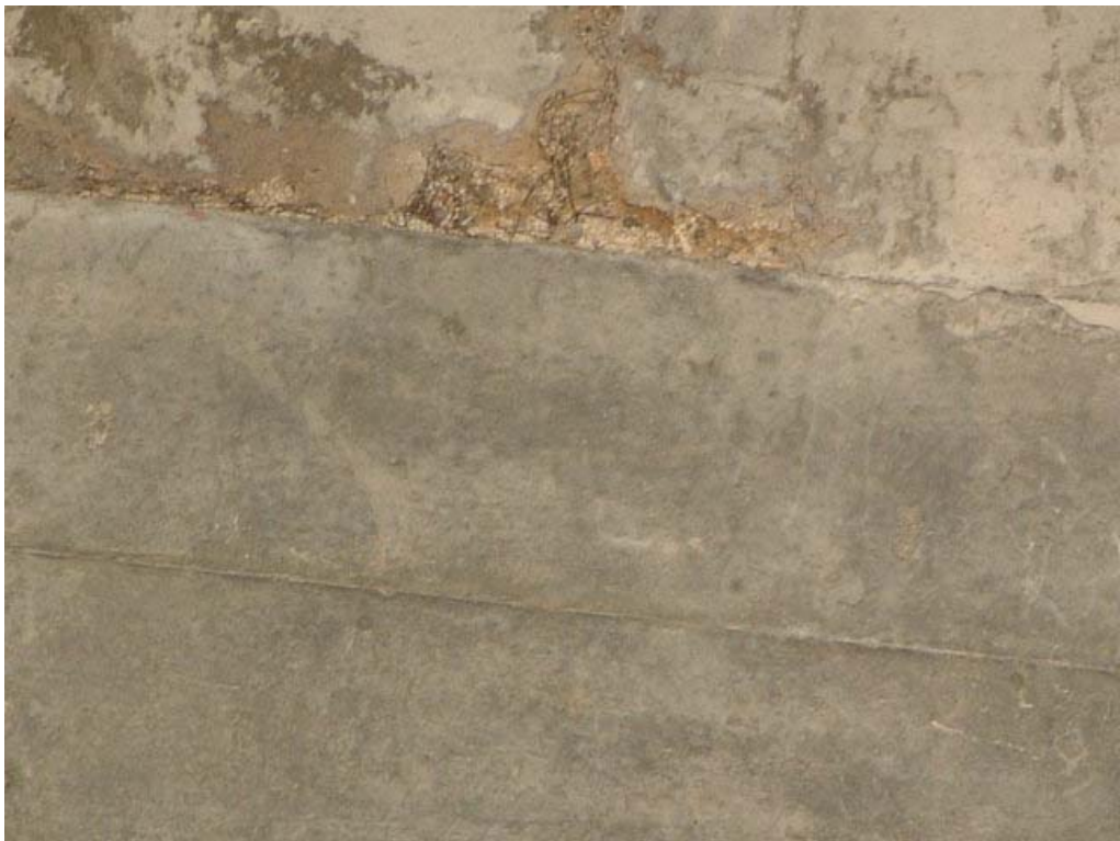
FOTOGRAFIA N° 14: LINEA TRANSVERSAL DEGRADADA, DETALLE
