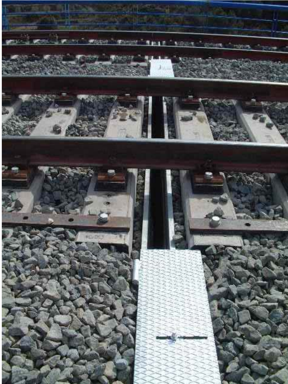
FOTOGRAFÍA N° 12: APARATO DE DILATACIÓN
