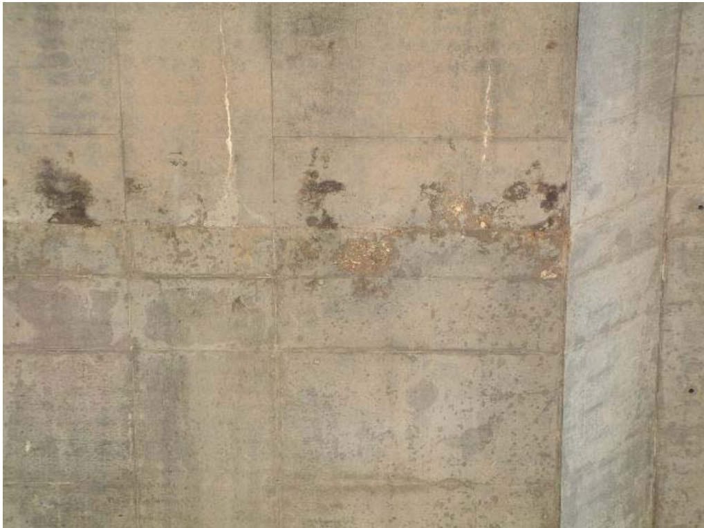
FOTOGRAFIA N° 15: JUNTA TRANSVERSAL DEGRADADA
