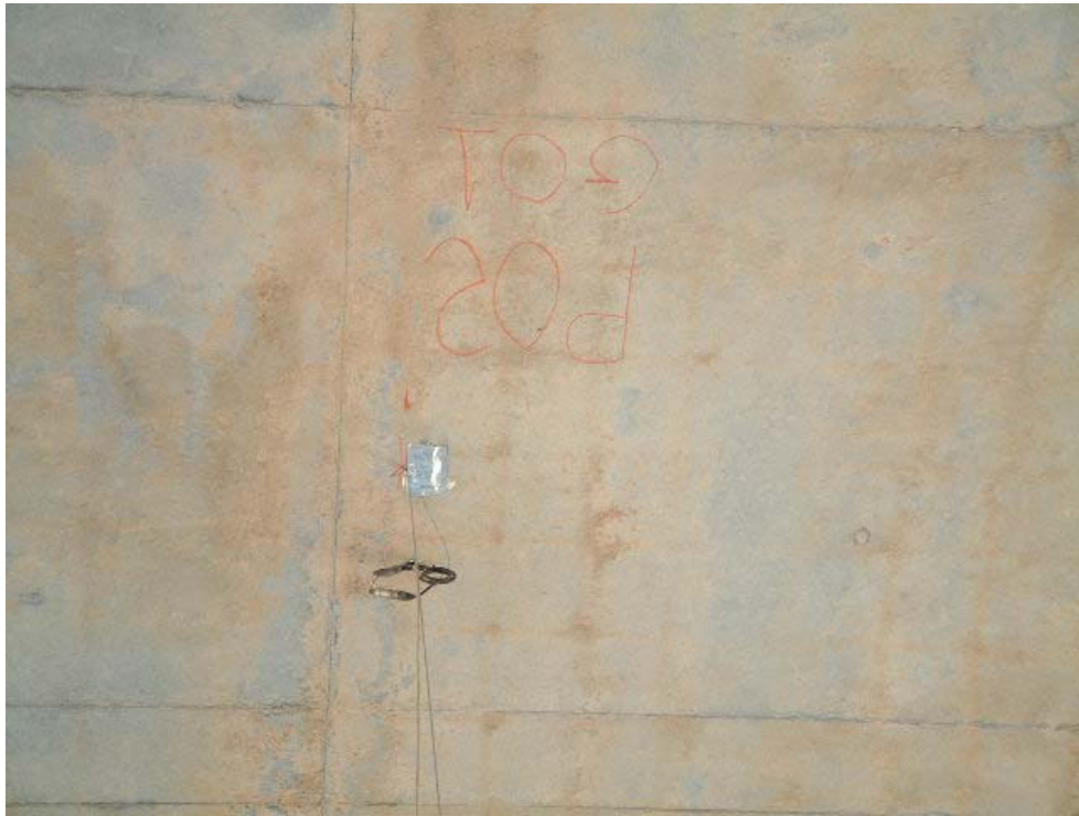
FOTOGRAFÍA 7: Banda extensométrica y flecha a L/2
