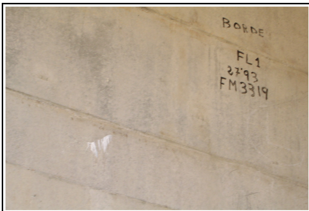
Foto 12: Humedad por filtración
