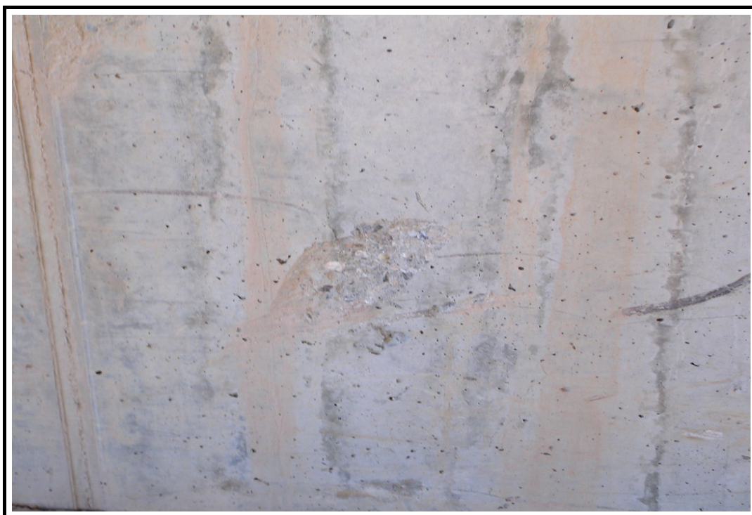
Foto 14: Desconchones en estribos
