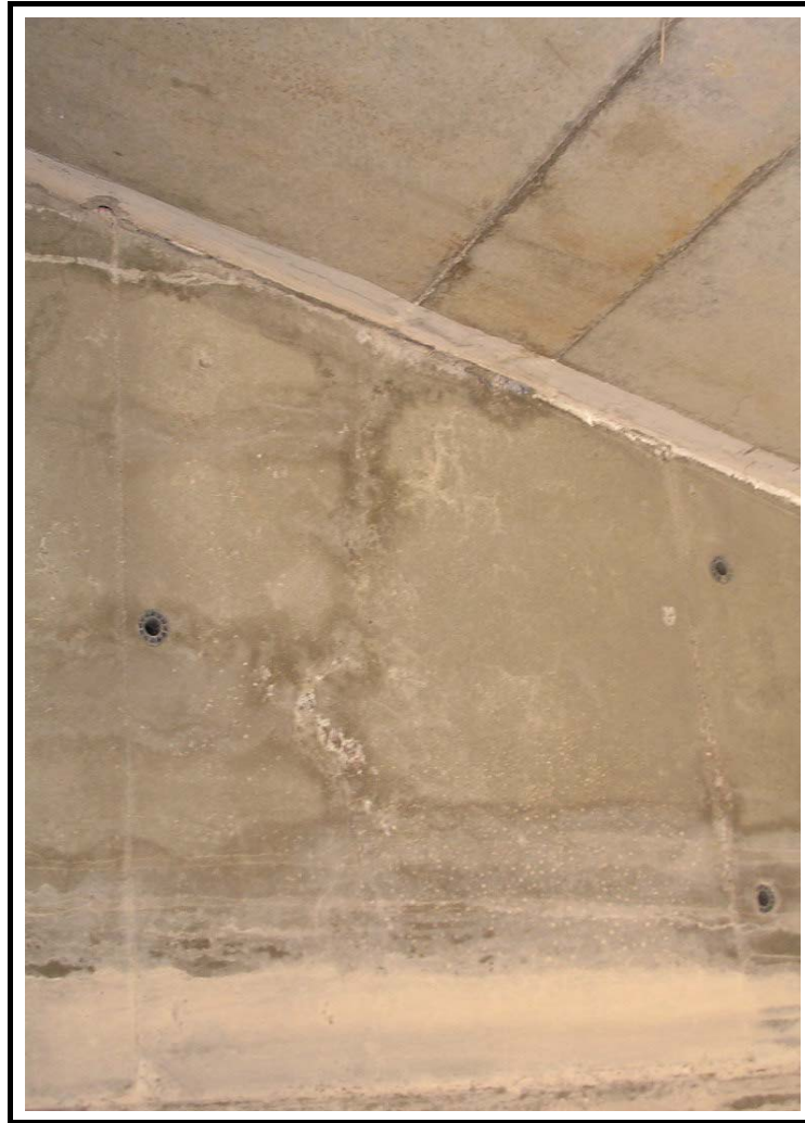
Foto 16: Fisuración en mapa en paramento de estribos
