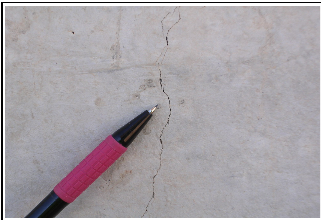
Foto 13: Fisuración vertical en pilas
