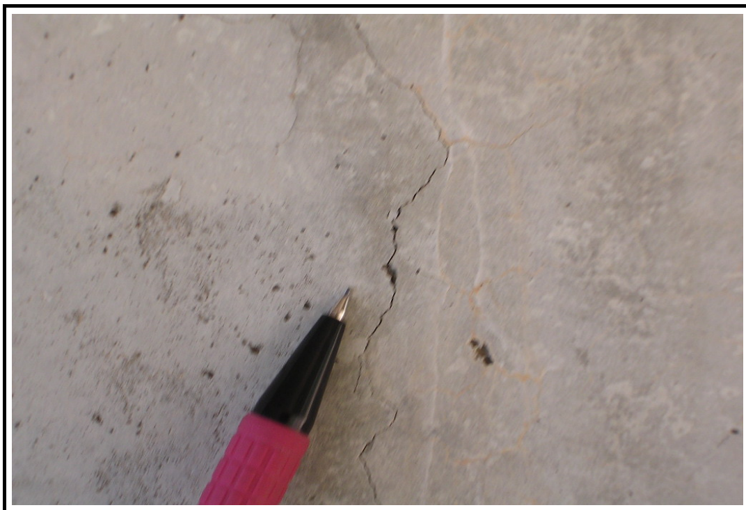
Foto 15: Fisuración vertical en estribos
