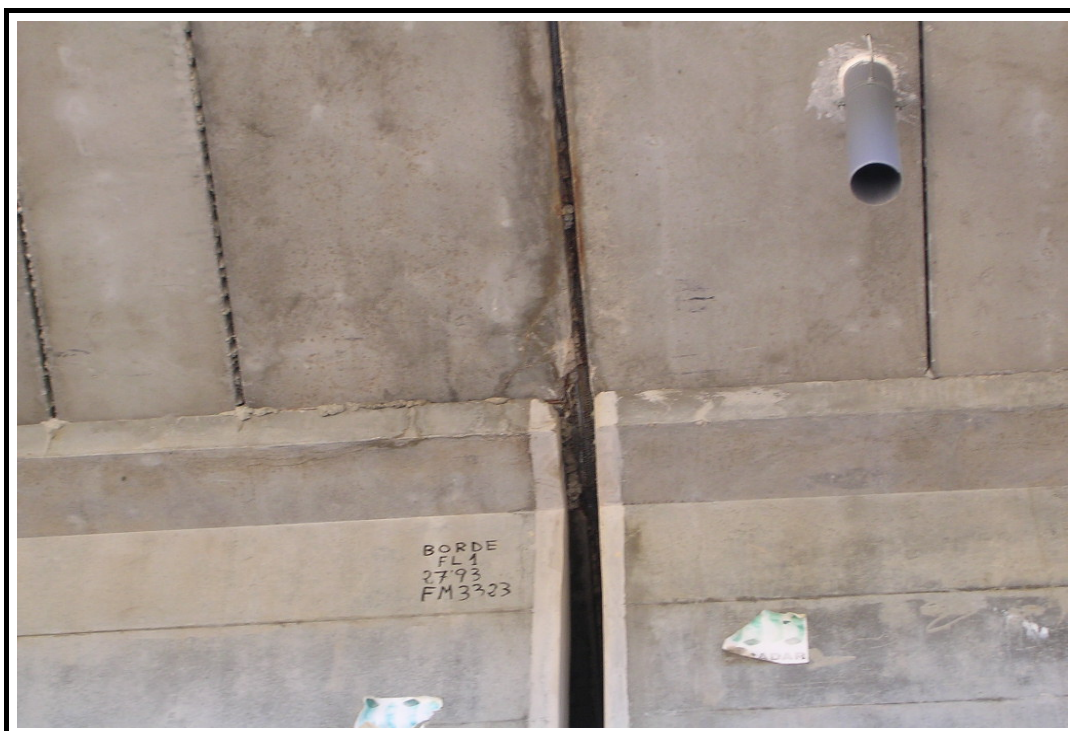
Foto 10: Golpe en viga
