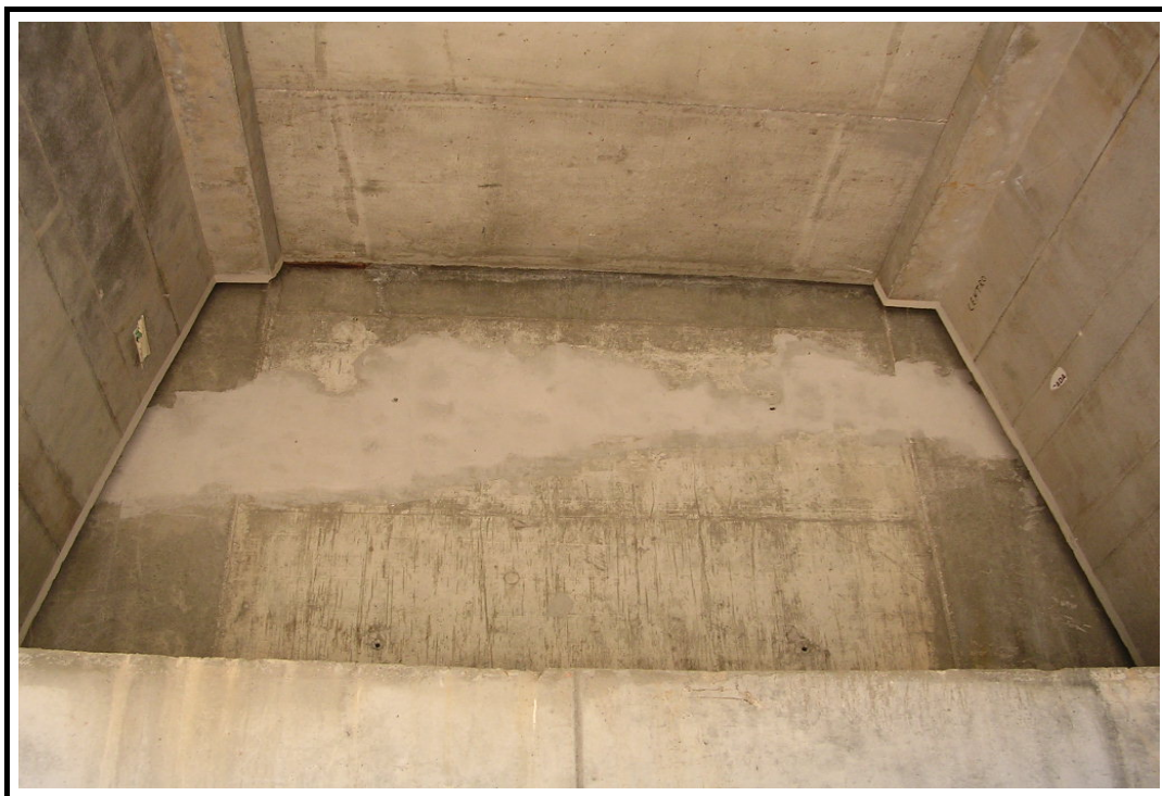
Foto 17: Fisuración en mapa en paramento de estribos
