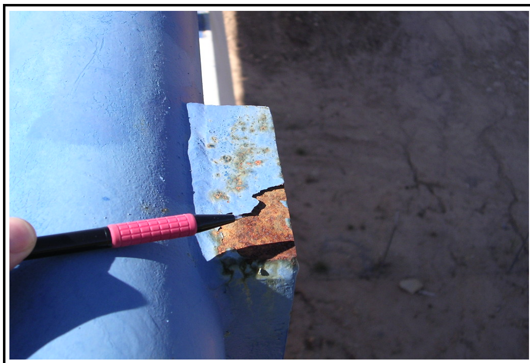
Foto 19: Picadura de barandillas
