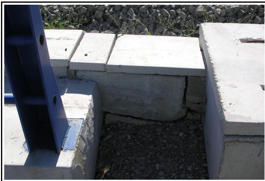
Foto 18: Rotura de canaleta
