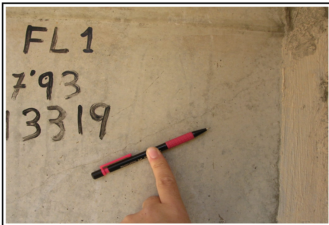
Foto 11: Fisura oblicua en alma de vigas
