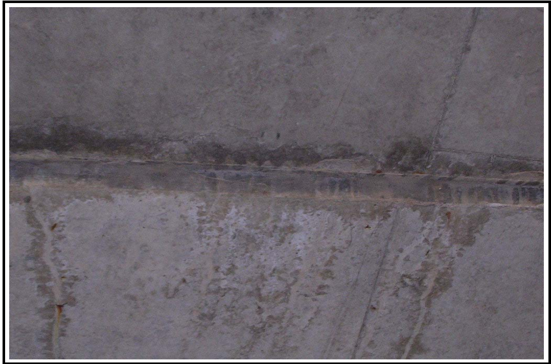
Foto 11: Humedades y circulación de agua
