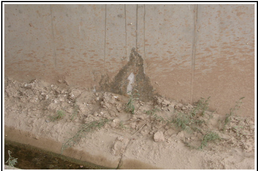
Foto 10: Eflorescencias en estribos
