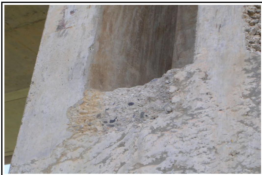
Foto 10: Desconchones por golpes en pilas
