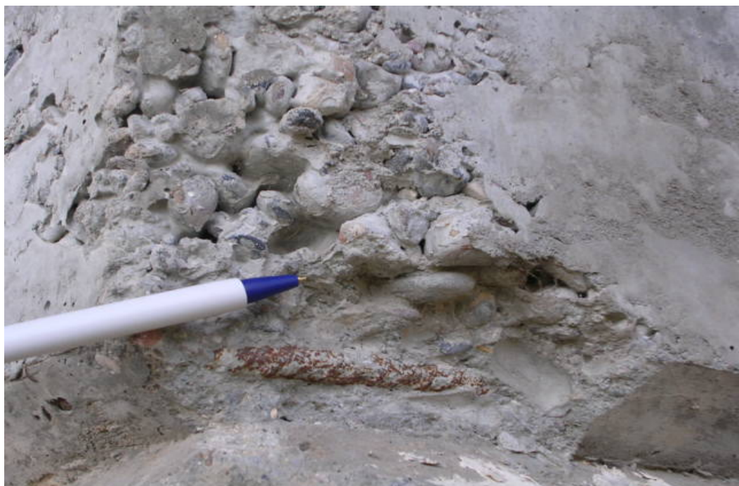
Foto 17: Nidos de grava con armadura vista en losa
