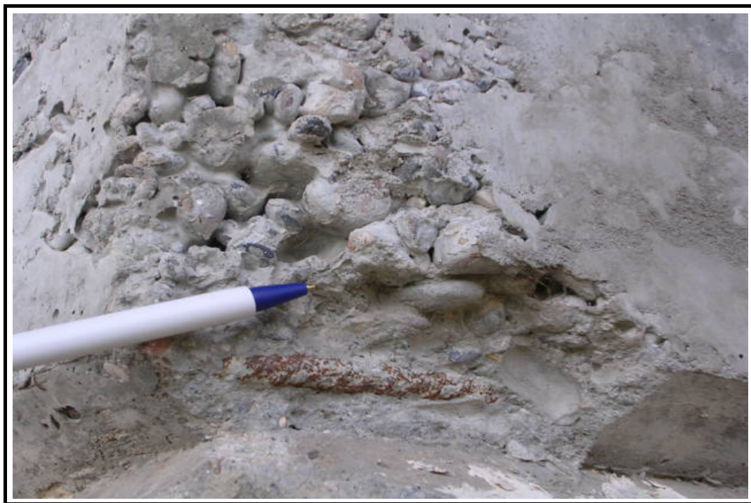
Foto 9: Avisperos con armaduras vistas en pilas
