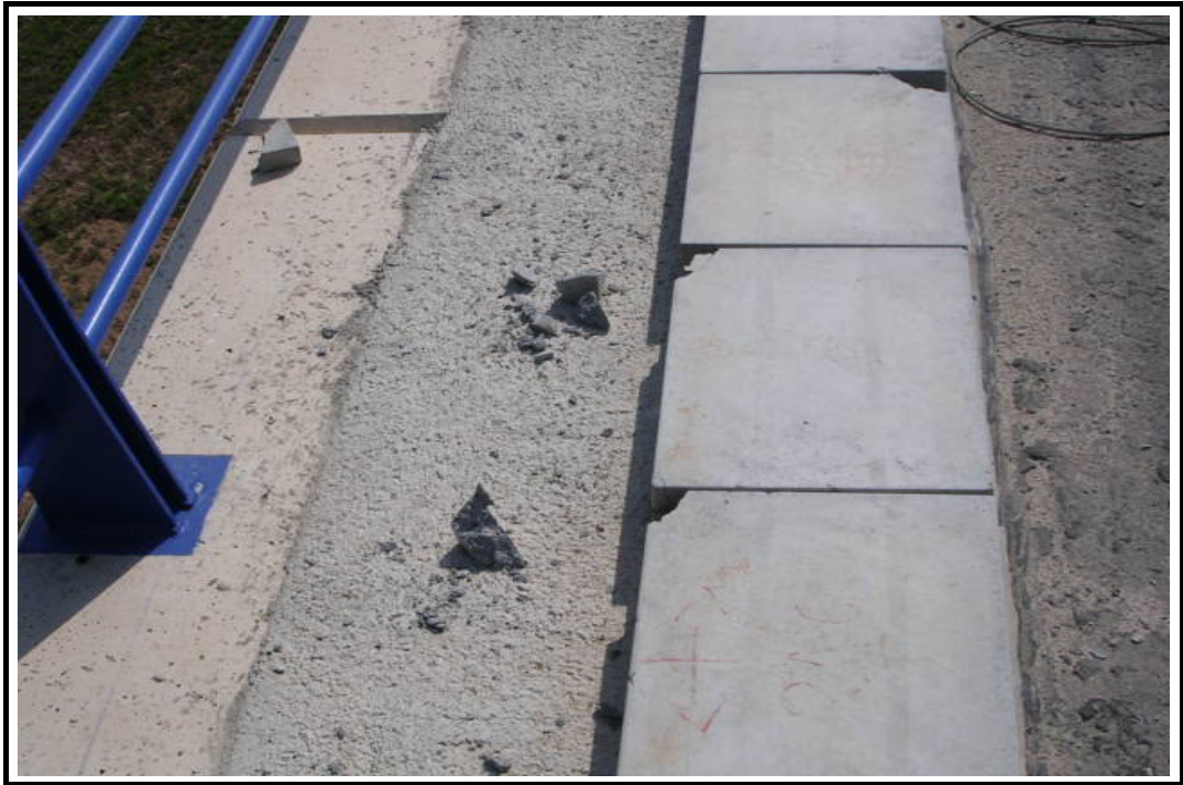
Foto 15: Rotura de tapas de canaletas
