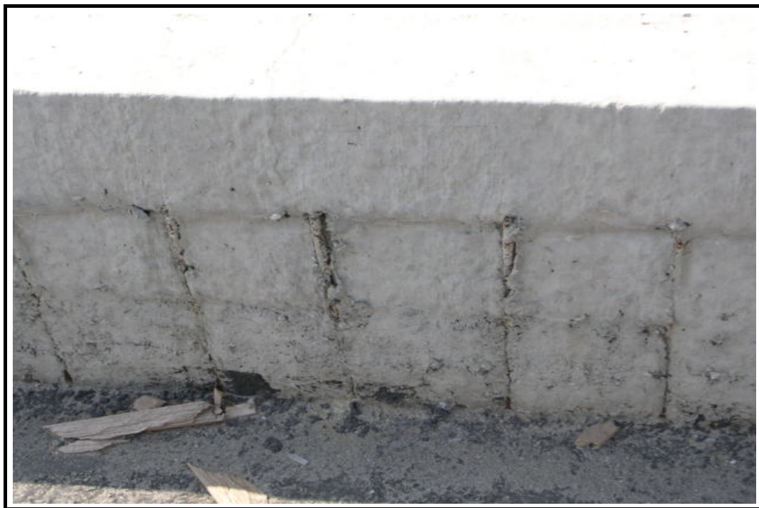
Foto 13: Armaduras vistas en murete guardabalasto
