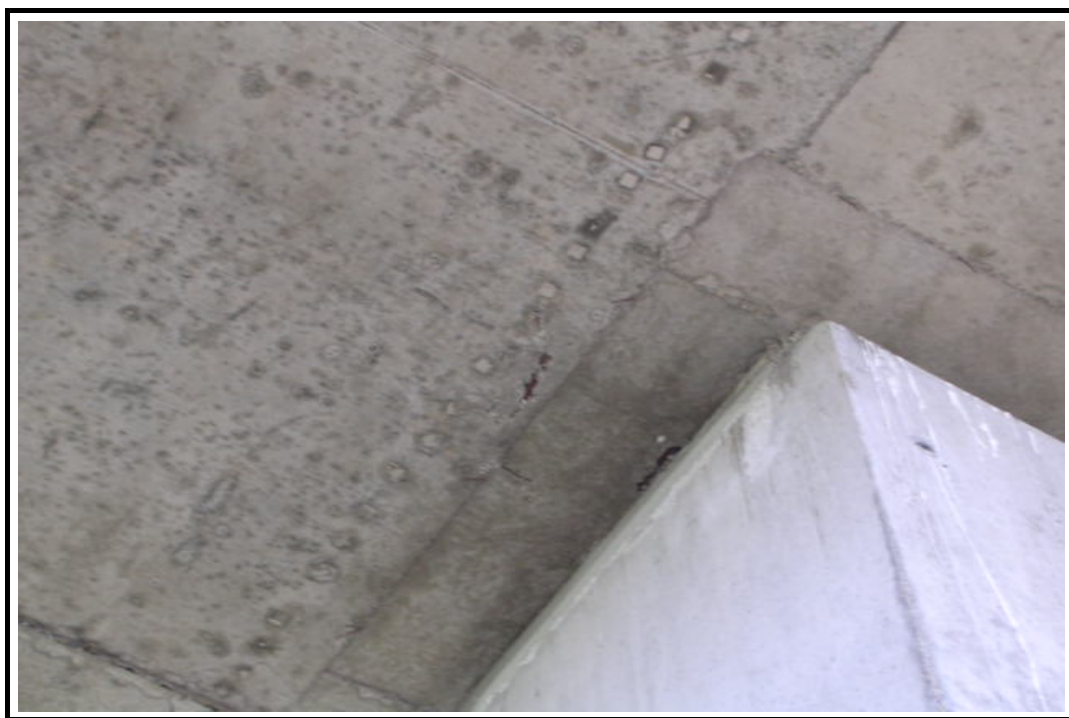
Foto 11: Avisperos con armaduras vistas en estructura de tramos
