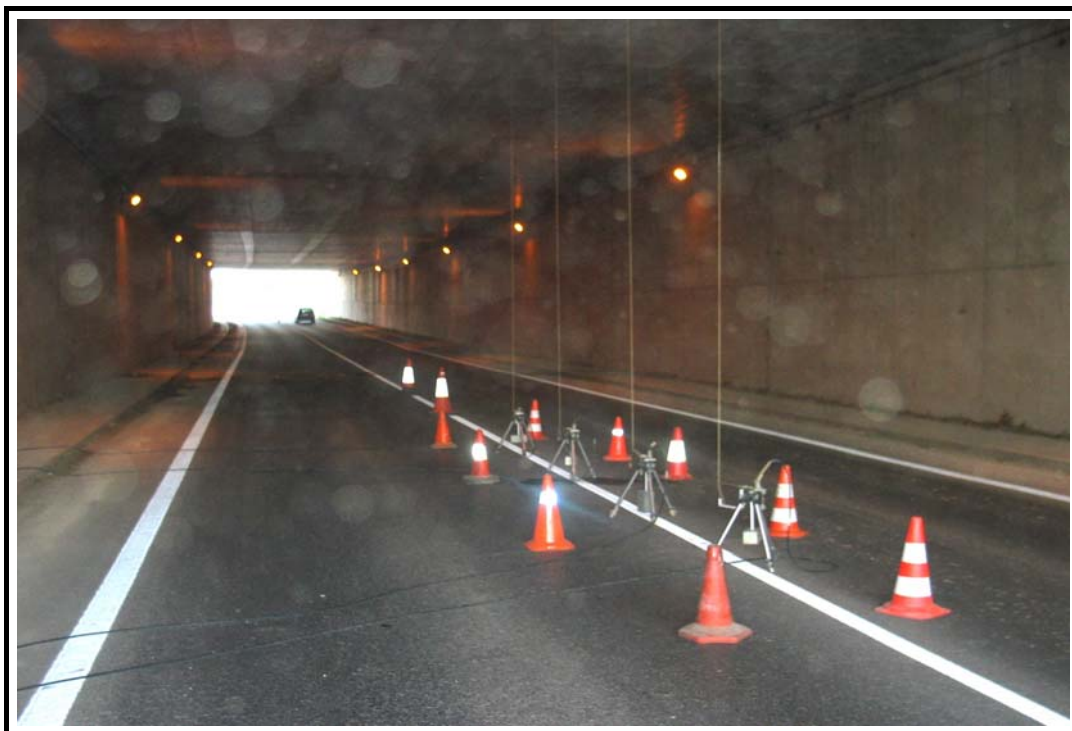
Foto 4: Línea de ménsulas para medida de flechas en centro de vano
