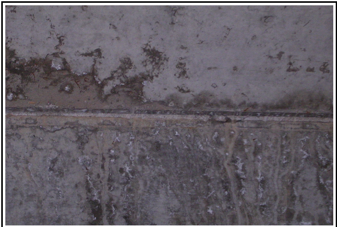
Foto 14: Humedad por filtración
