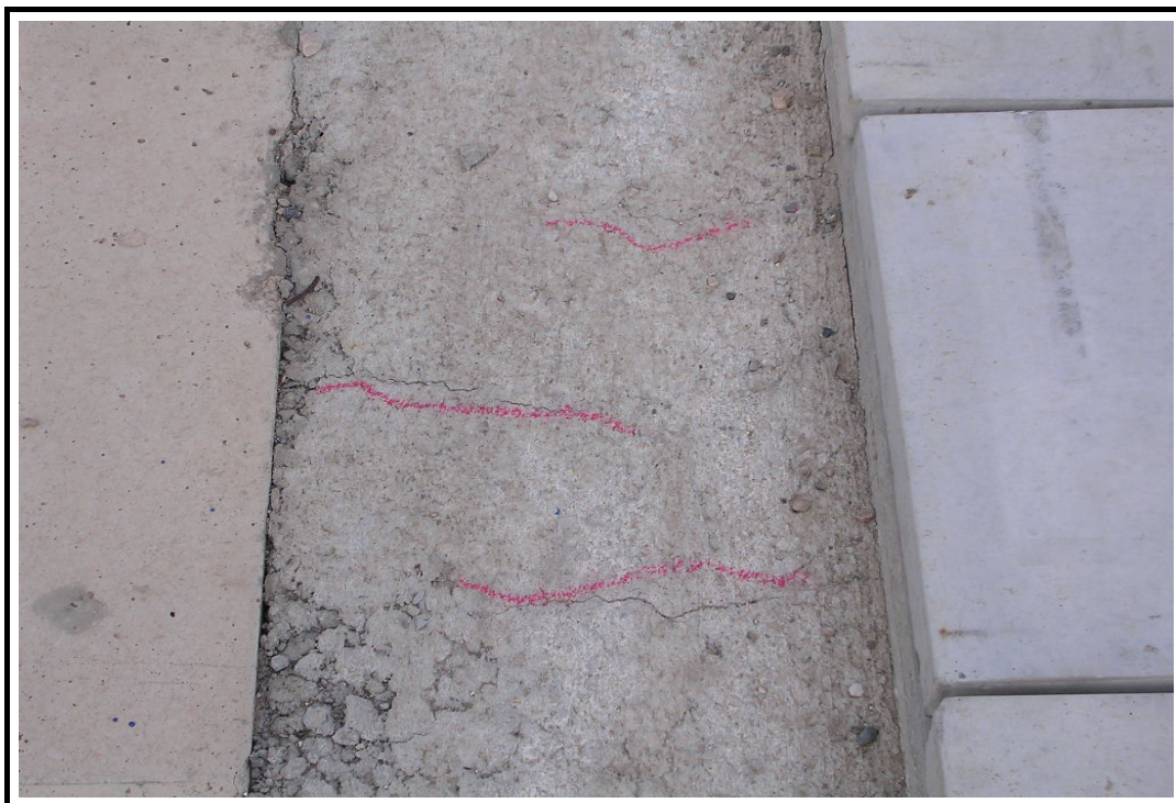
Foto 8: Fisura por oxidación de armaduras
