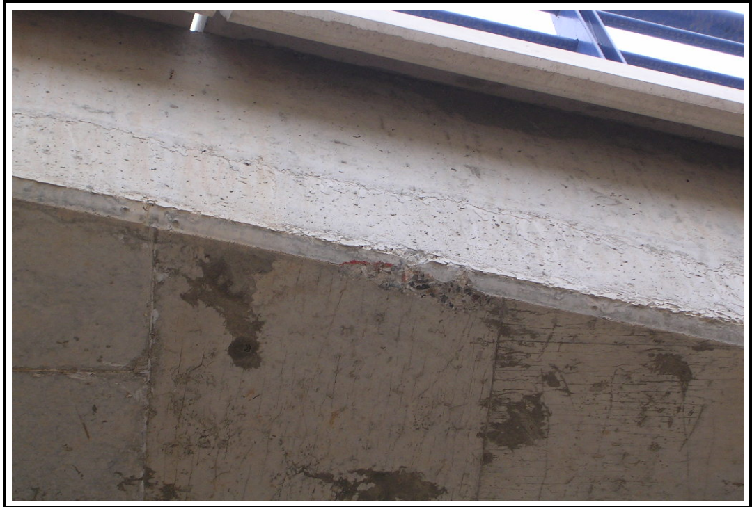
Foto 9: Desconchón por golpe en dintel
