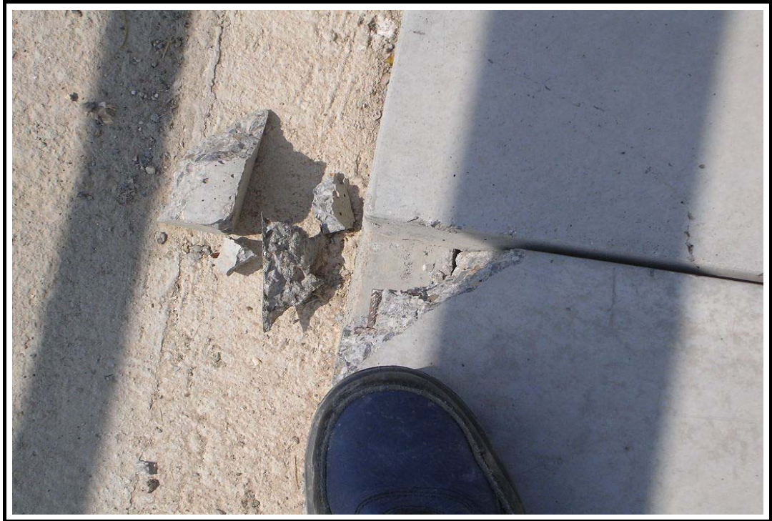
Foto 11: Rotura de canaleta
