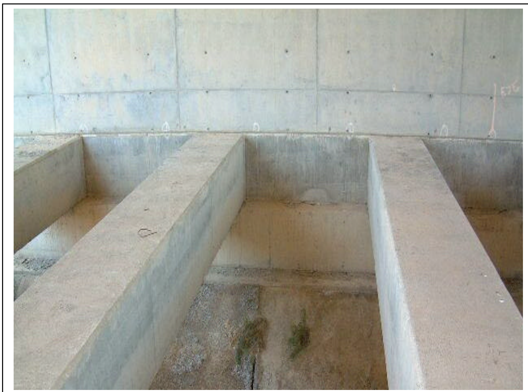
FOTOGRAFÍA N° 8: FISURAS EN LA CIMENTACIÓN DEL ESTRIBO DE ENTRADA
