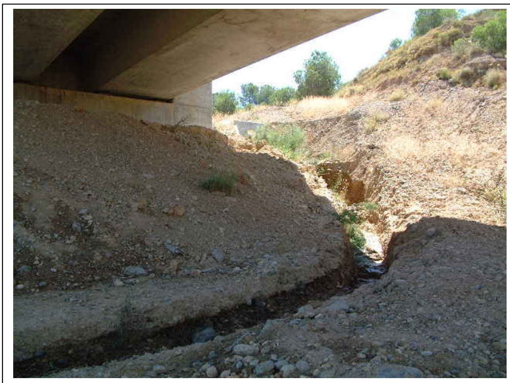
FOTOGRAFÍA Nº 15: CANALETA DESAGÜE LD SALIDA
