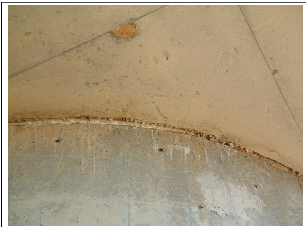
FOTOGRAFÍA N° 8: DETALLE FISURA EN TABLERO SOBRE E1 EN LI
