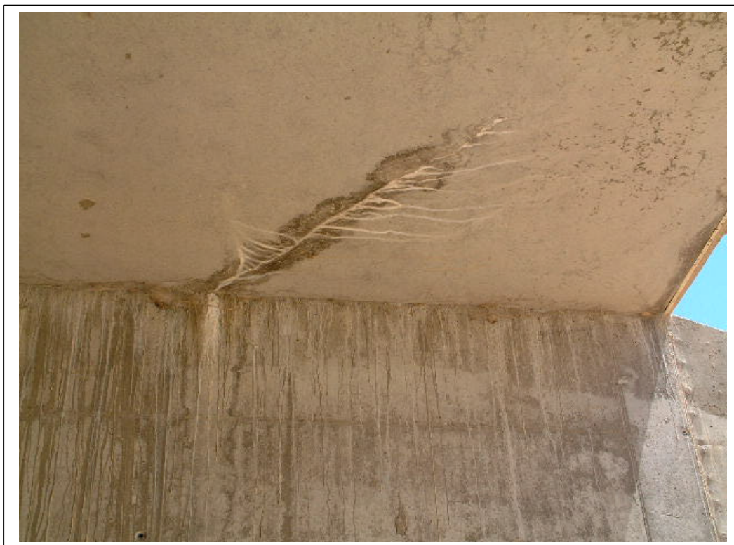
FOTOGRAFÍA N° 8: DETALLE FISURA LOSA E2 LD
