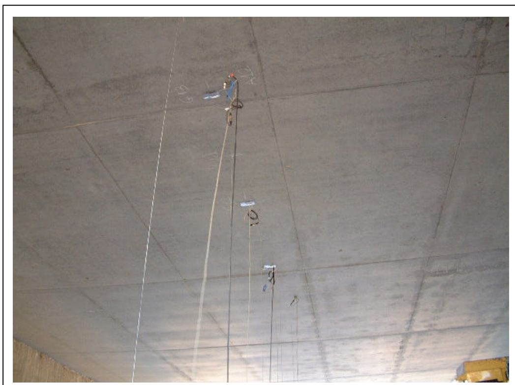
FOTOGRAFÍA 8: Detalle equipos de medida
