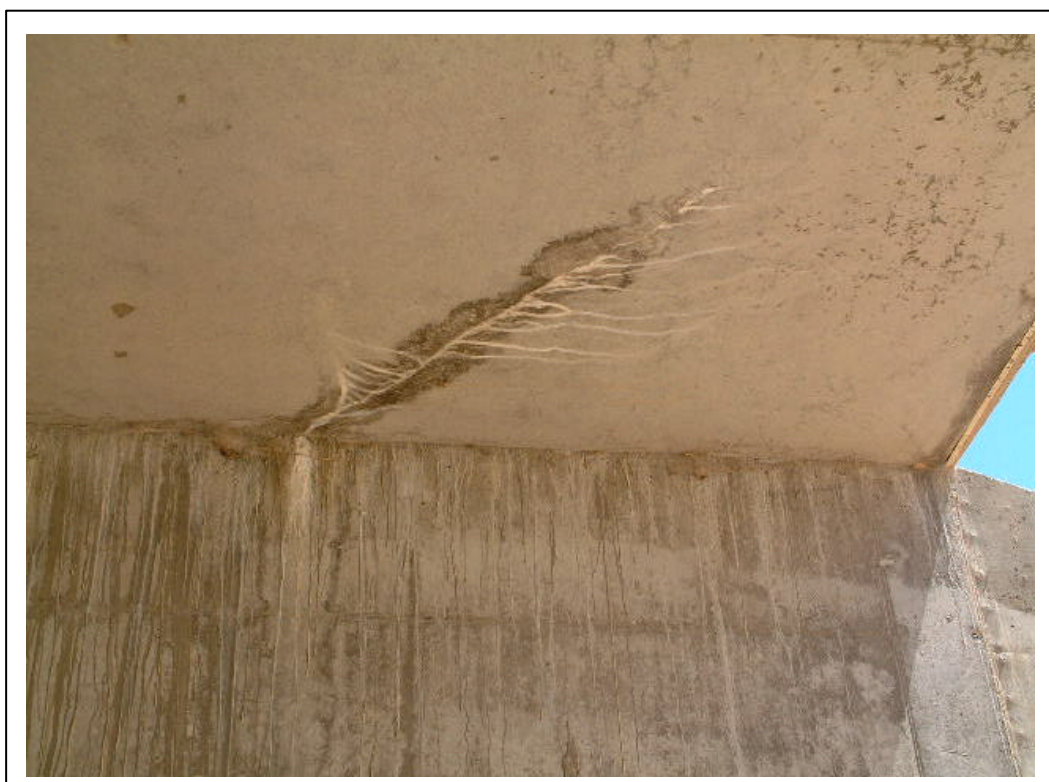
FOTOGRAFÍA 6: Detalle fisura losa E2 LD
