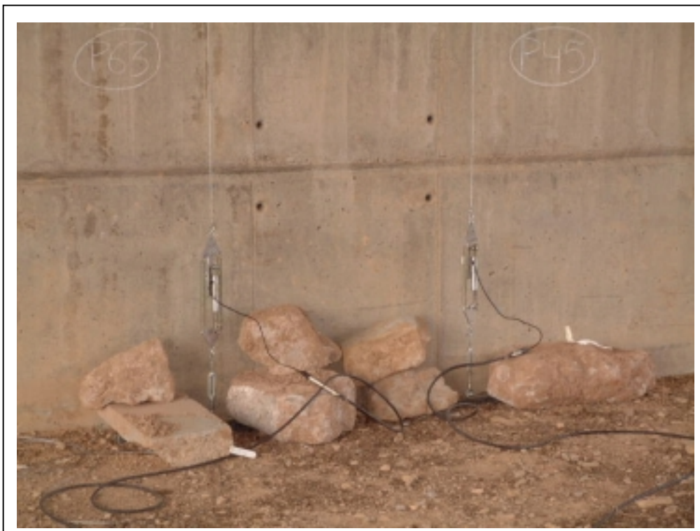
FOTOGRAFÍA 6: Transductores de desplazamiento en apoyos
