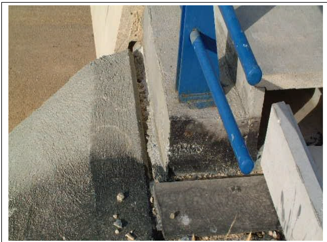
FOTOGRAFÍA N° 8: JUNTA SOBRE EL ESTRIBO DE ENTRADA LI.
