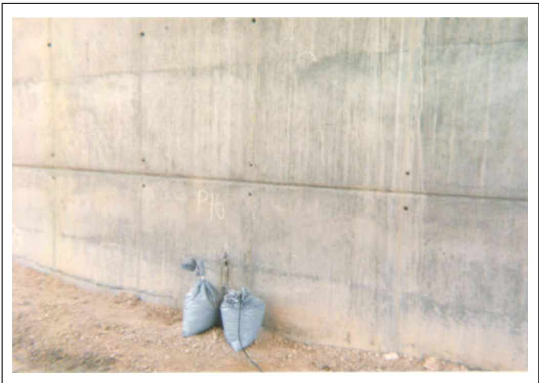
FOTOGRAFÍA 6: Transductor de desplazamiento en apoyo
