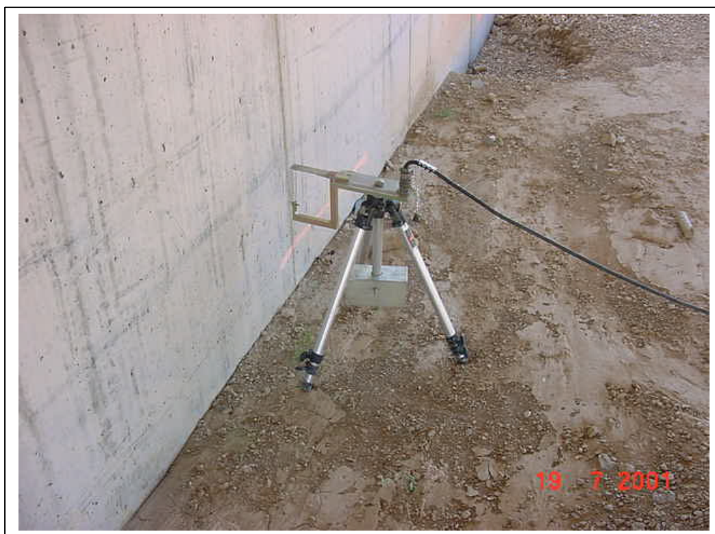
FOTOGRAFÍA 12: Detalle de instrumentación junto a estribo
