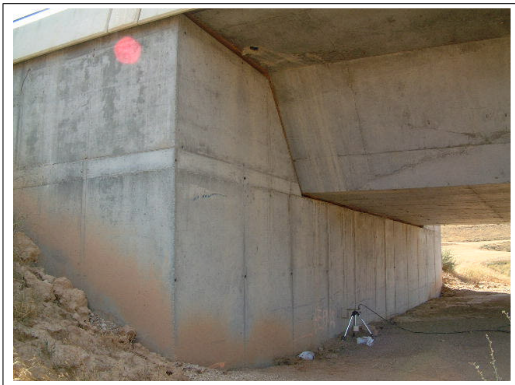
FOTOGRAFÍA 11: Instrumentación junto a estribo
