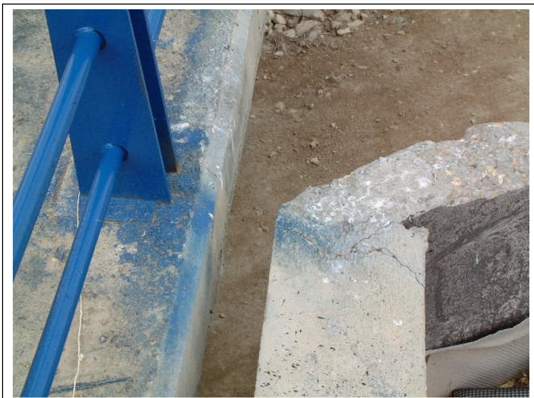
FOTOGRAFÍA Nº 8: FISURA EN ALETA/TESTERO LI E2.
