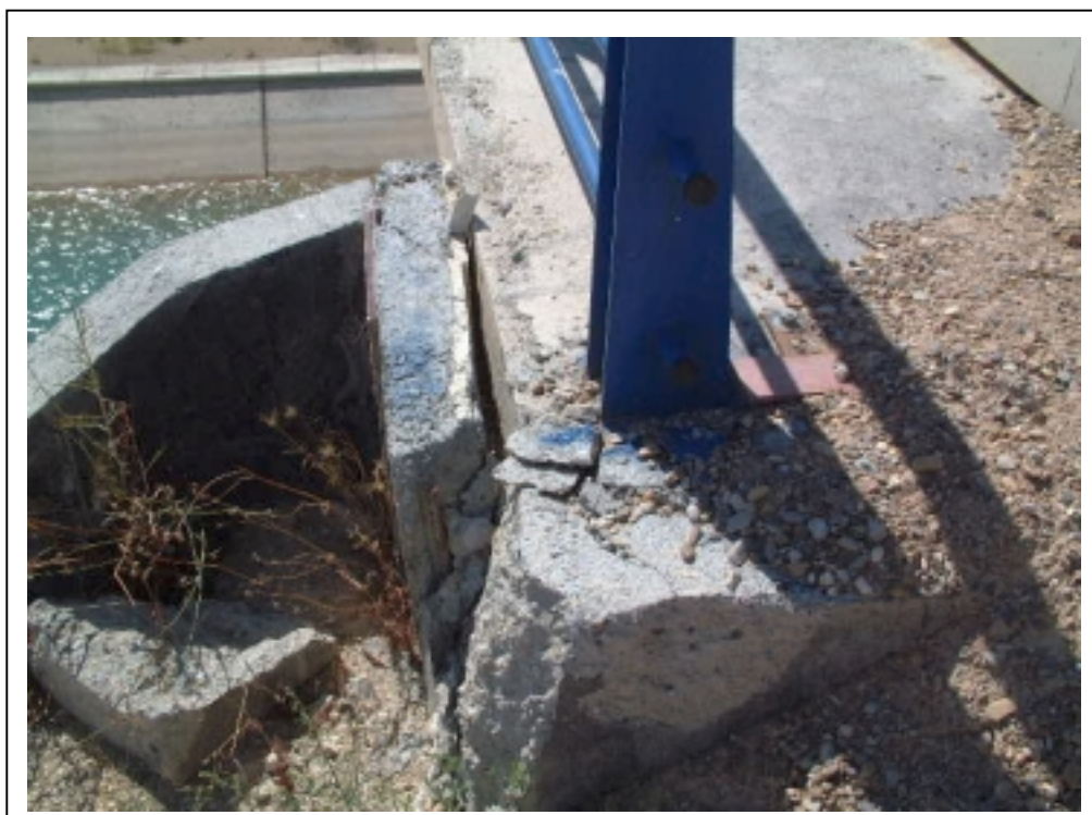
FOTOGRAFÍA 10: Detalle desperfecto junto a barandilla
