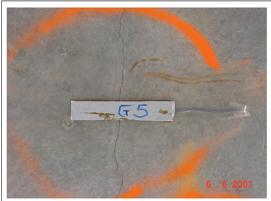
FOTOGRAFÍA 7: Detalle de galga extensométrica en fisura
