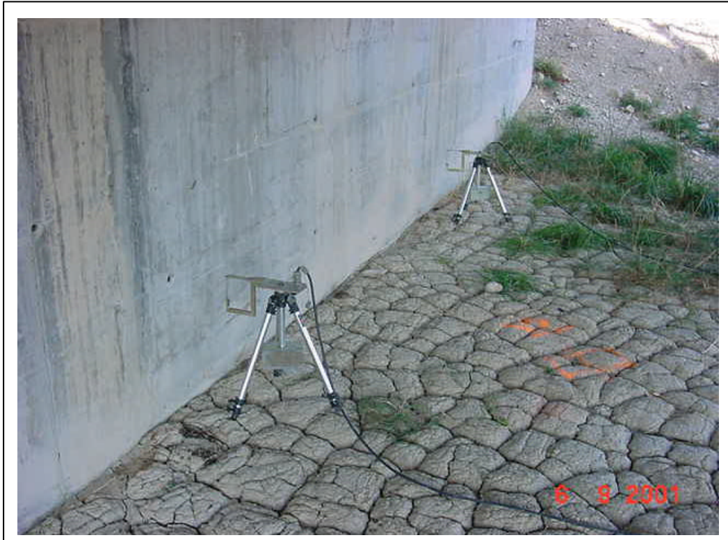
FOTOGRAFÍA 5: Detalle de instrumentación junto a estribo
