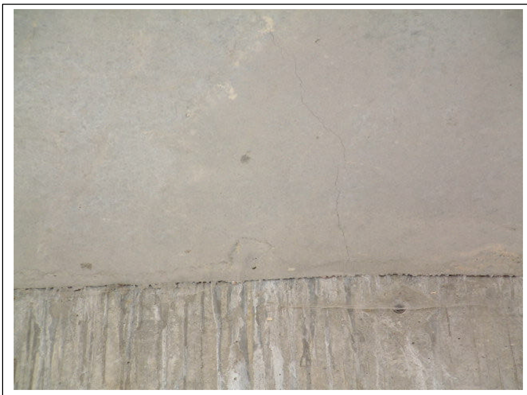
FOTOGRAFÍA Nº 9: FISURA EN TABLERO JUNTO E2 A 2,00 M DE LI.
