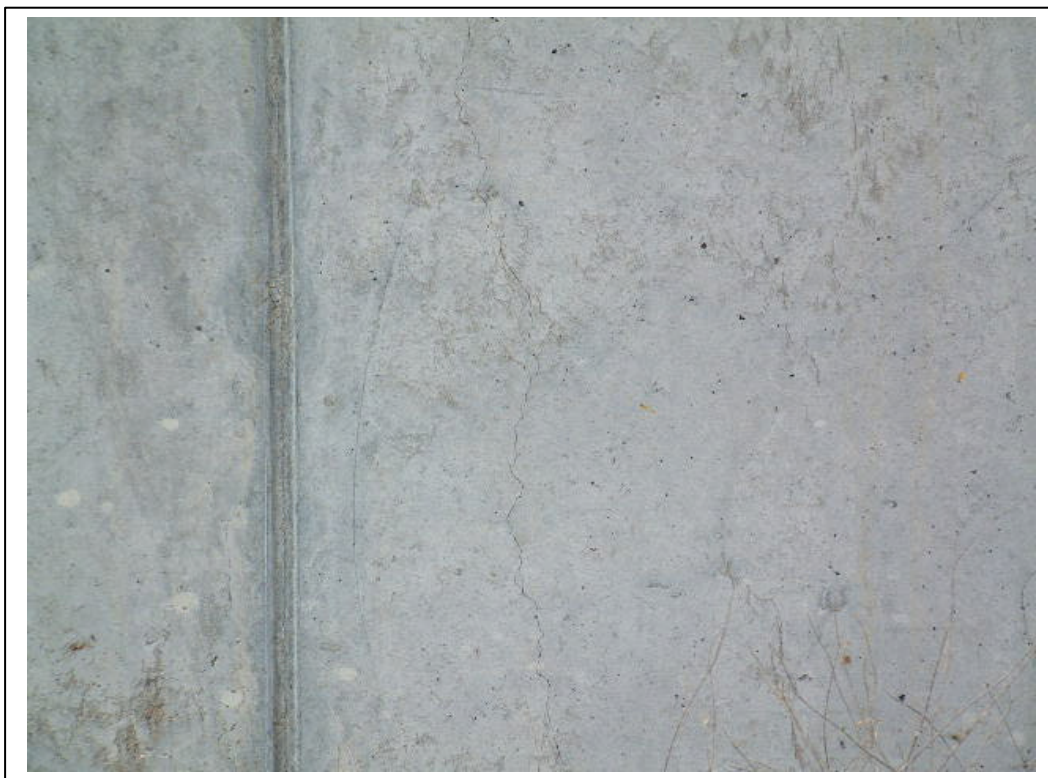
FOTOGRAFÍA N° 8: FISURA VERTICAL EN ESTRIBO DE ENTRADA A 3,50 M DE LD.
