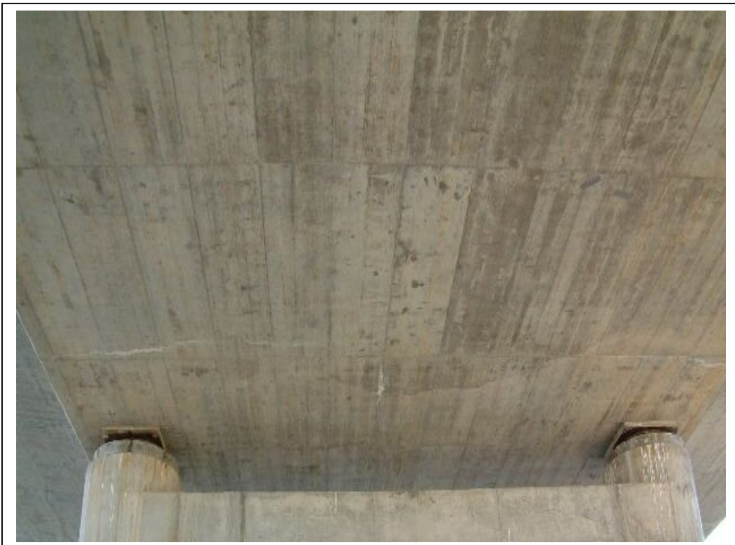
FOTOGRAFÍA N° 8: DETALLE FISURA TRANSVERSAL TABLERO TRAMO 2
