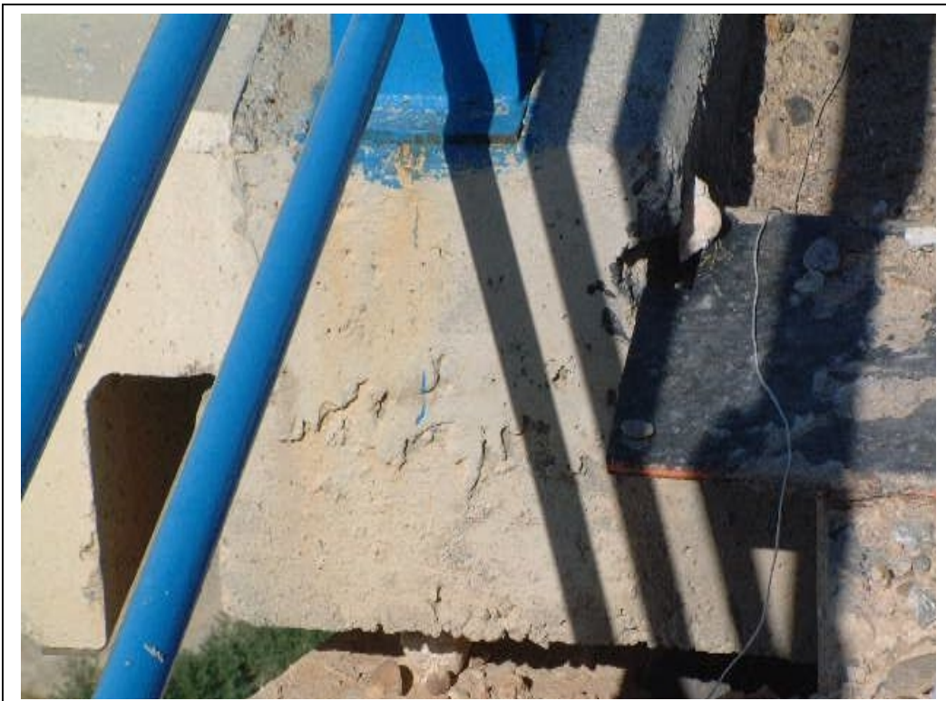
FOTOGRAFÍA Nº 10: JUNTA SOBRE EL ESTRIBO DE SALIDA EN LD.
