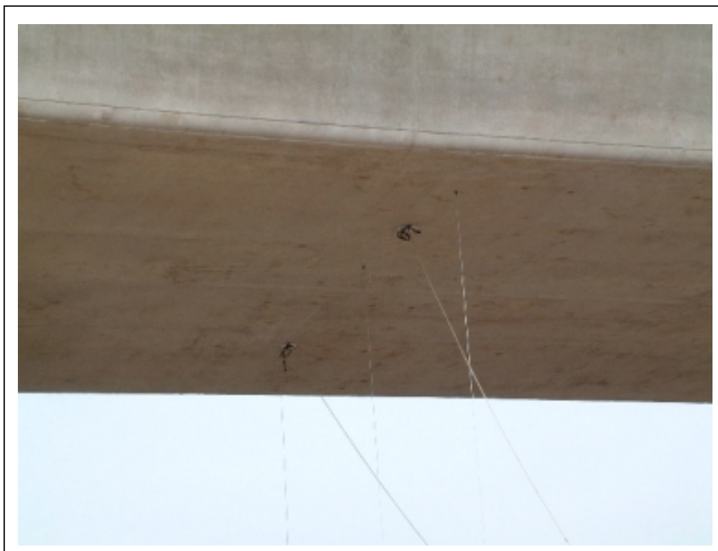
FOTOGRAFÍA 7: Instrumentación en centro de vano
