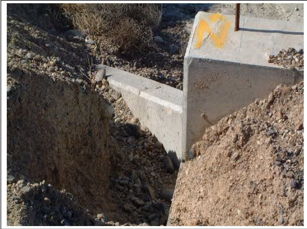
FOTOGRAFÍA Nº 11: SOCAVACIÓN TRASDÓS ESTRIBO DE ENTRADA LI.
