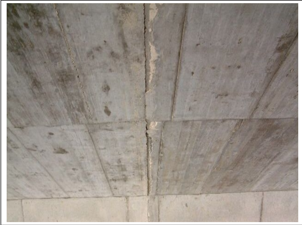
FOTOGRAFÍA Nº 9: JUNTA LONGITUDINAL EN TRAMO 1 Y ESTRIBO ENTRADA
