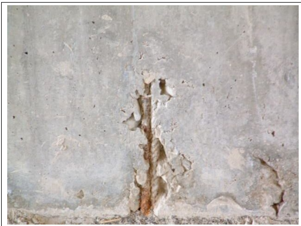
FOTOGRAFÍA N° 9: PILA 1, FRONTAL EN CENTRO ARMADURA VISTA
