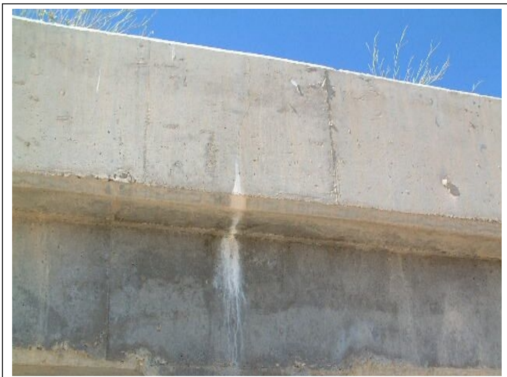
FOTOGRAFÍA N° 8: FISURA SOBRE PILA 2 EN LATERAL DERECHO
