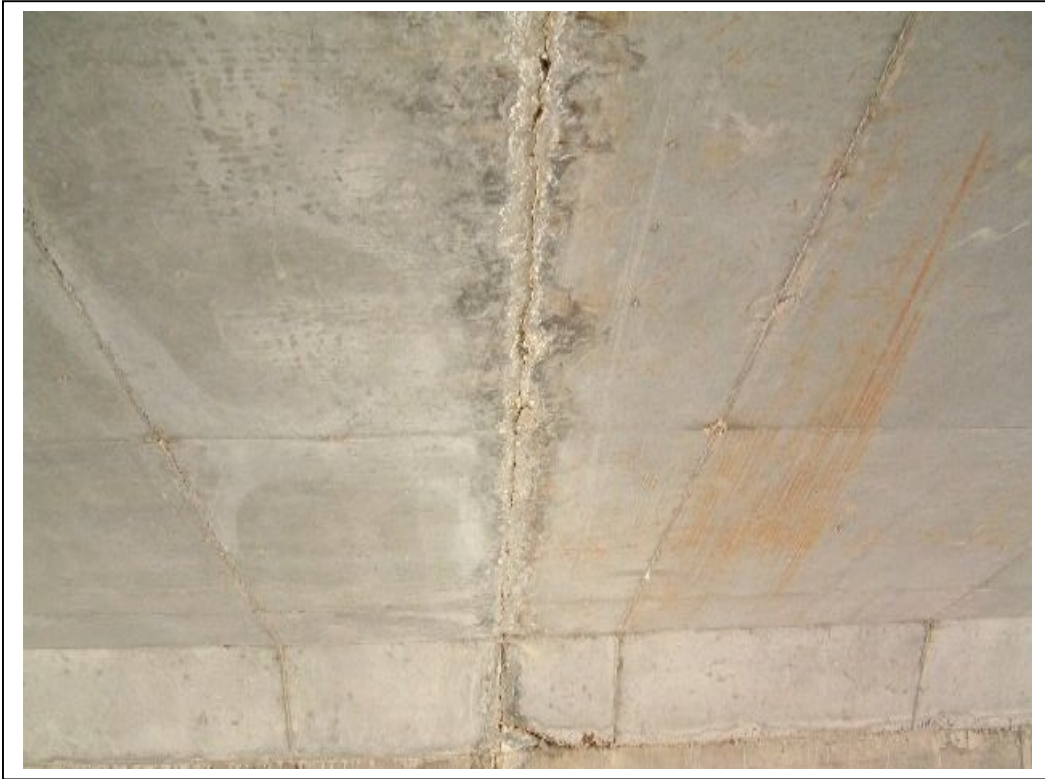
FOTOGRAFÍA Nº 11: DETALLE JUNTA LONGITUDINAL EN TRAMO 2 Y PILA 1
