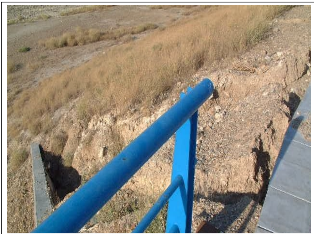
FOTOGRAFÍA N° 9: SOCAVACIÓN EN EL TRASDÓS DE LA ALETA FRONTAL LI.
