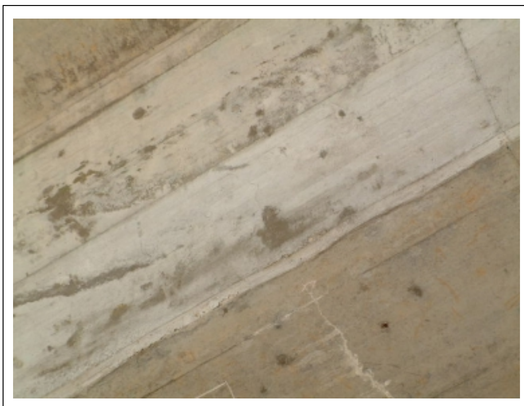
FOTOGRAFÍA 12: Eflorescencias y fisuración
