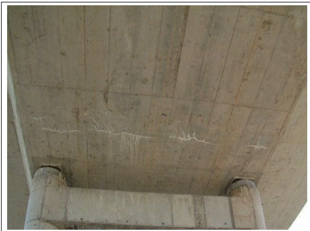
FOTOGRAFÍA Nº 11: DETALLE FISURA TRANSVERSAL TABLERO TRAMO 2
