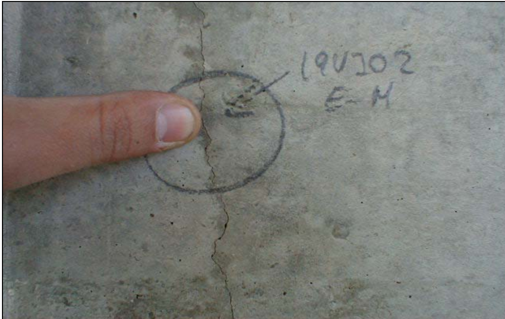
Foto 9: Fisura en estribo de entrada (Madrid).
