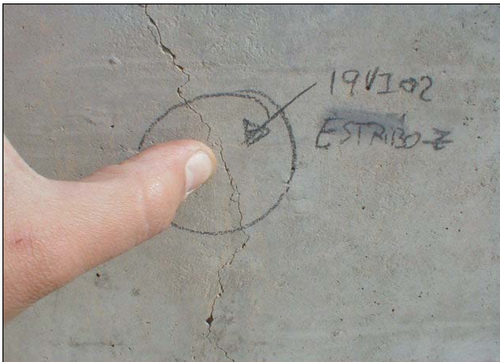
Foto 8: Fisura en estribo de salida (Zaragoza).
