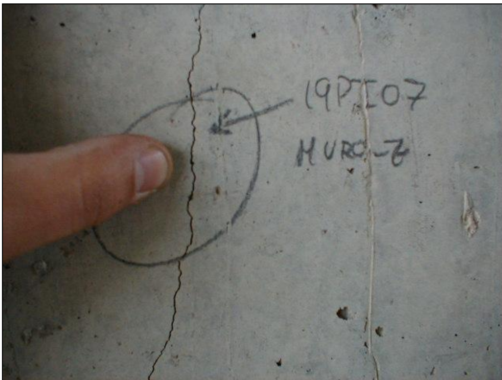
Foto 6: Detalle de fisuración vertical en el muro del estribo Zaragoza.
