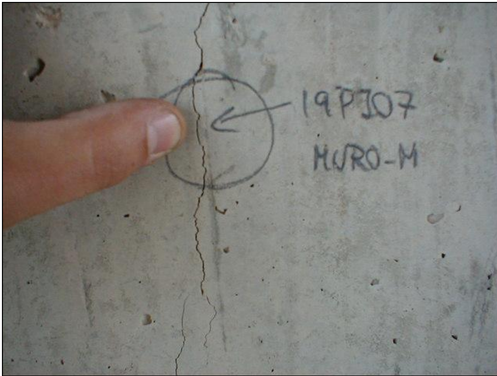
Foto 5: Detalle de fisuración vertical en el estribo Madrid.
