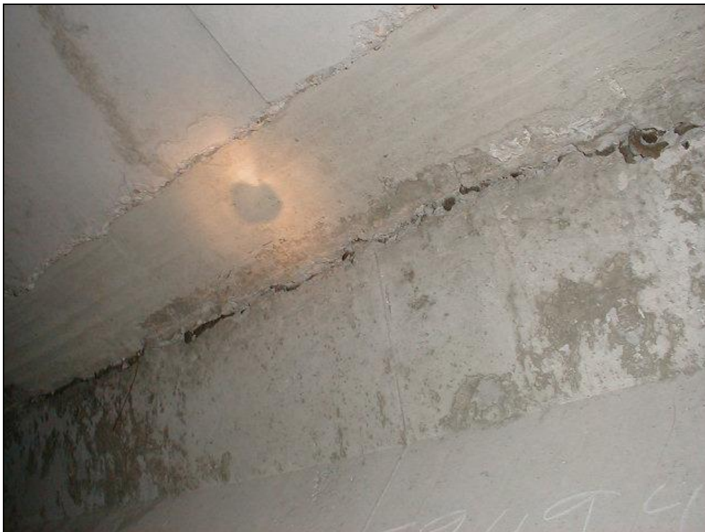
Foto 11: Grietas en el interior del cajón
